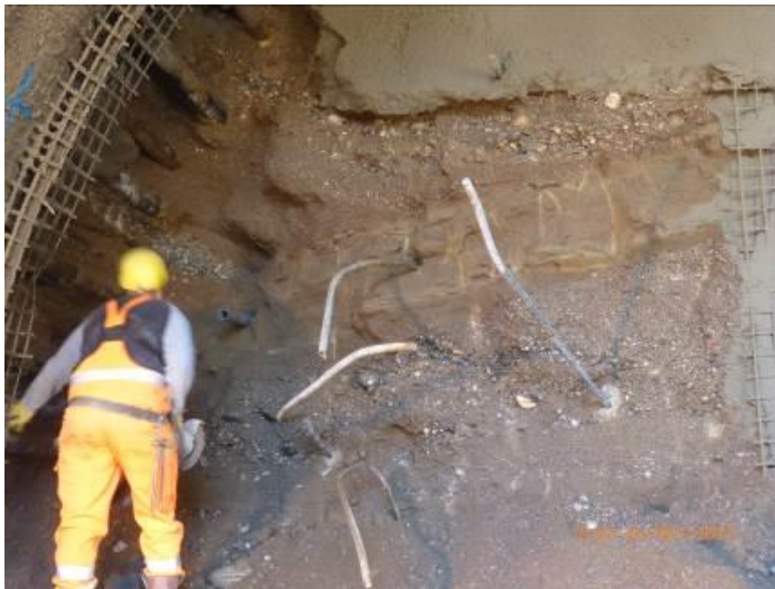
Obr. 15 Dílčí výrub kaloty, střídání terasových písků a štěrků tunel Lager Berg 2, TM 5,6 Fig. 15 Partial excavation of top heading, alternation of terrace sands and gravels, tunnel Lager Berg 2, TM 5.6
