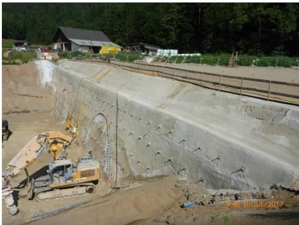
Obr. 24 Pohled na portálovou stěnu tunelů Langer Berg, realizovanou již pod násypem z armovaných zemin.
