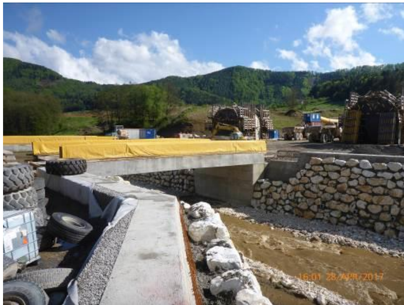
Obr. 25 Pohled na objekt SA1, „most pro tunely“ Fig. 25 View on object SA1 „bridge for tunnels“
