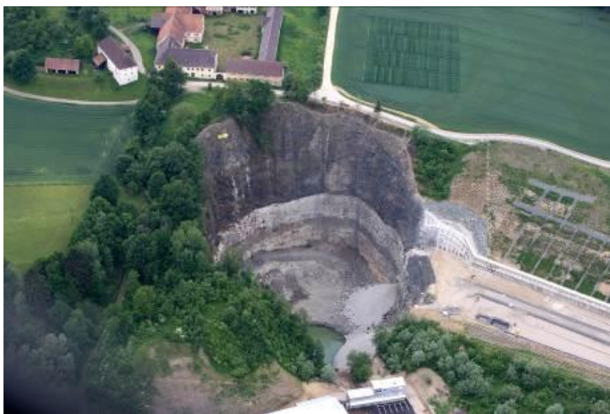
Obr. 4 Pohled na vytěžený bazaltový lom, budoucí portály tunelů Deutsch Grutschen Fig. 4 A view of the extracted basalt quarry, the future northern portal of the Deutsch Grutschen tunnels
