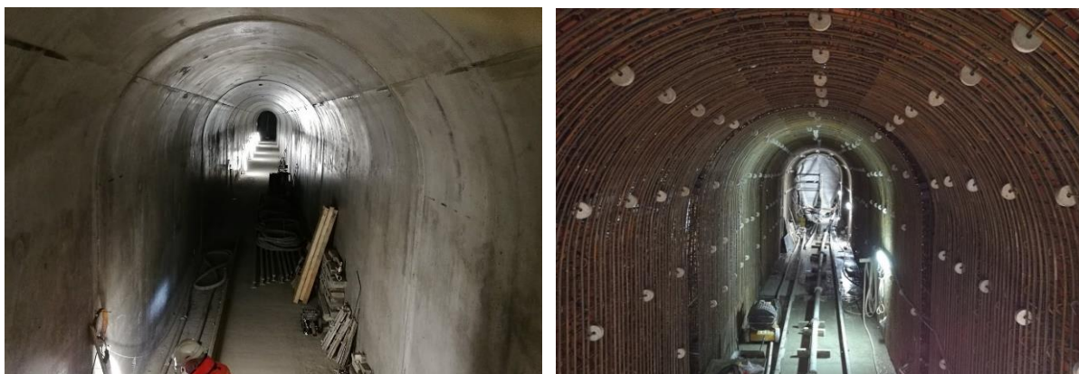
Obr. 12 a 13 Hotové betonové definitivní ostění hlavní trasy (vlevo); Výztuž definitivního ostění klenby (vpravo)
