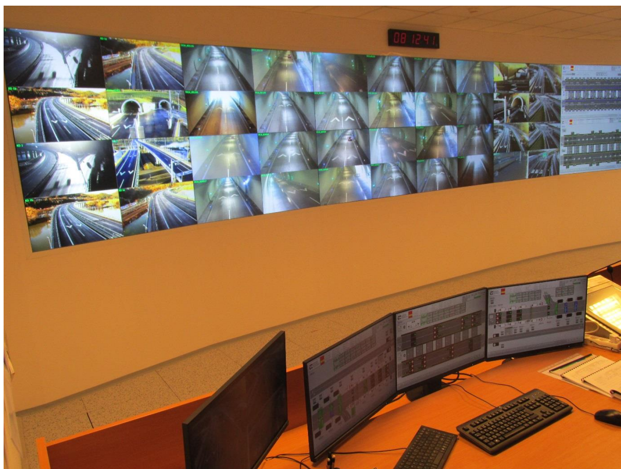
Obr. 3 Novovybudované integrované operátorské pracovisko
