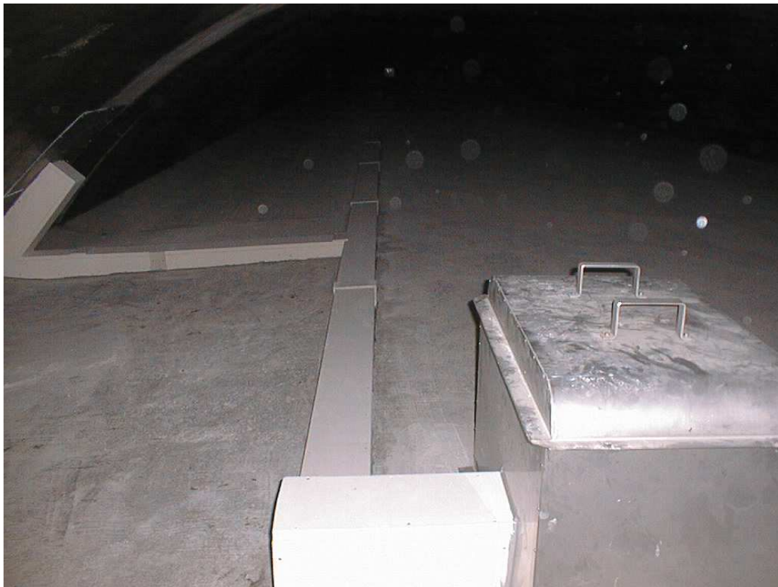
Obr. 5 Izolácia ovládacích káblov žalúzií v medzistropě. Tunel Branisko Fig. 5 Shutter control cable insulation. Tunnel Branisko
