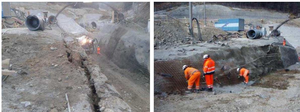
Obr. 10 Poškozený svah zářezu přístupové cesty a jeho dodatečné zajišťování.
