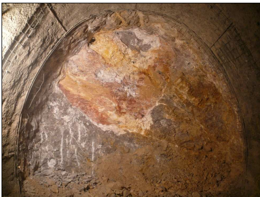
Obr. 11 Fotografie čela výrubu v devonských vápencích lochkovského souvrství, kde je patrné korozní krasové zvětření horninového masivu až do hloubek 90 m pod terénem
