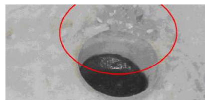
Porucha 7 - Vydrolený beton
