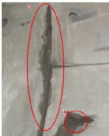
Porucha 3 - Průsak vody spárou, Porucha 4 - Průsak vody šroubovým spojem
