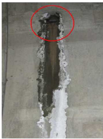
Porucha 5 - Průsak vody otvorem pro naváděcí kužel erektoru
