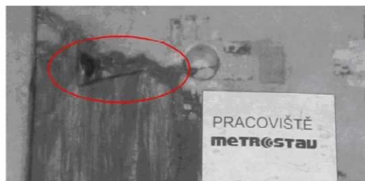
Porucha 2 - Trhlina s průsakem vody
