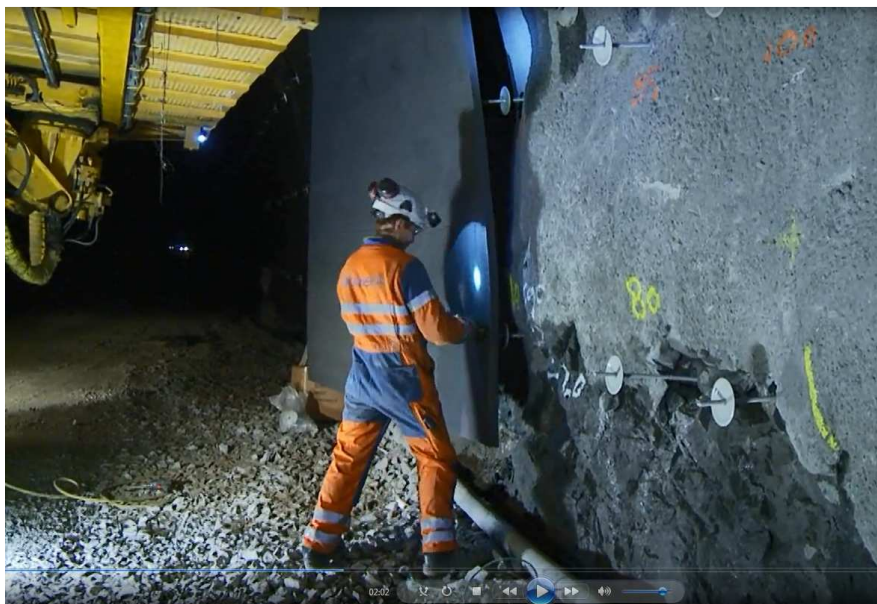
Obr. 6 Osadenie PE peny napichnutím na predmontované svorníky Fig. 6 Assembling of PE foam insulation on preinstalled bolts
