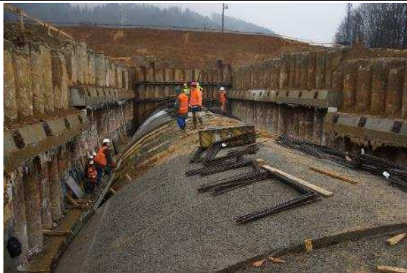
Obr. 8 Vyrovnávací beton pro dosažení přesného tvaru želvy Fig. 8 Levelling concrete for achieving the precise shape of the “tortoise shell” vault
