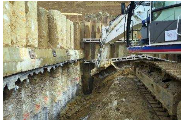
Obr. 7 Tvarování dna jámy pro betonáž želvy Fig. 7 Shaping the excavation pit bottom for casting the concrete “tortoise shell” structure
