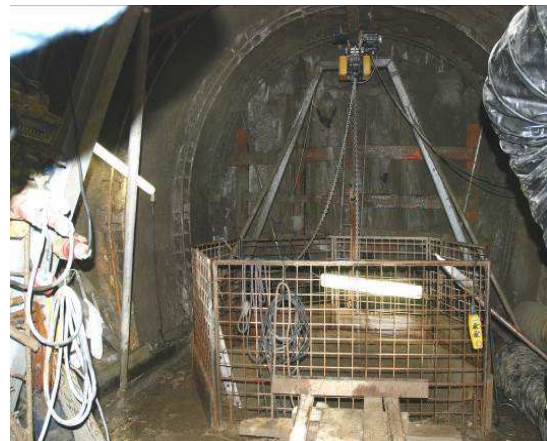
Obr. 5 Kaverna s těžním zařízením Fig. 5 Cavern with mining equipment
