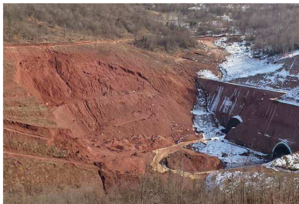
Obr. 21 Západní portál – sesutý levý svah Fig. 21 West Portal – collapsed left slope
