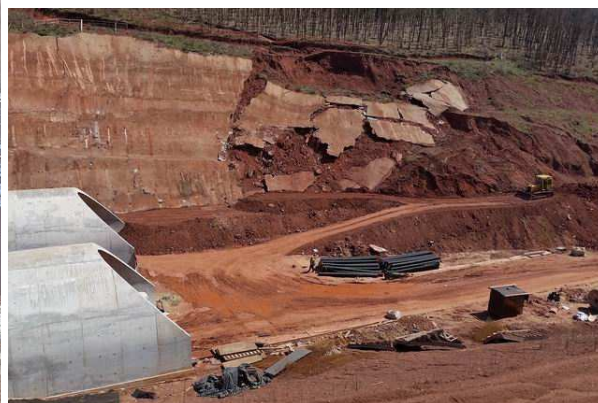
Obr. 22 Východní portál – sesutý levý svah Fig. 22 East Portal – collapsed left slope
