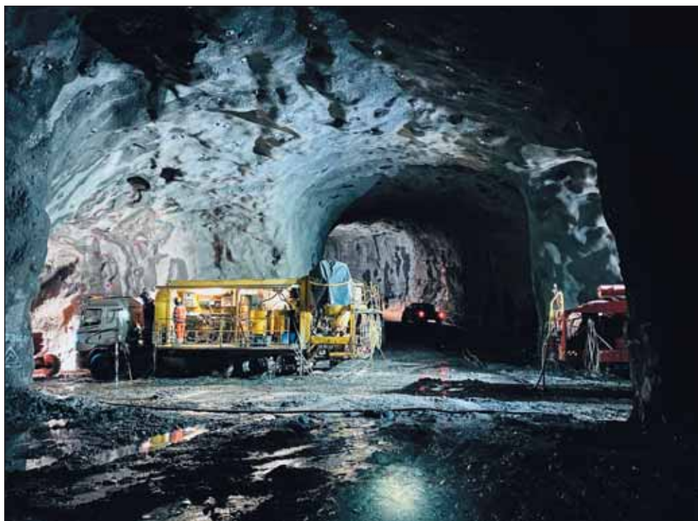
Obr. 13 Injektáž traťových tunelů – mobilní injektážní jednotka Fig. 13 Grouting into the bifurcation of running tunnels – a mobile grouting unit
