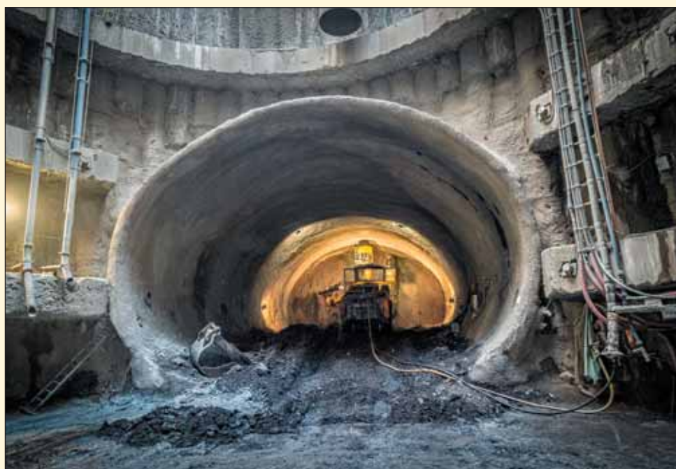
Obr. 2 Pohled na část vyraženého dvoukolejného tunelu na lokalitě VO-OL Fig. 2 View down the excavated double-track tunnel in the VO-OL locality
