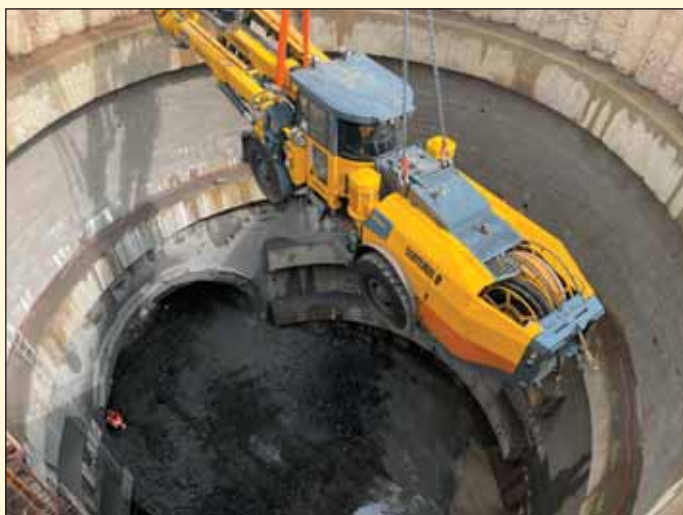
Obr. 1 Momenta spouštění vrtacího stroje do stávající šachty při zahájení ražeb na lokalitě PAD1b
