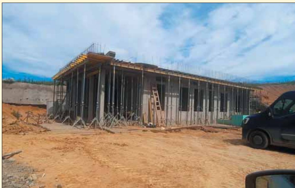
Obr. 9 Technologická centrála na južnom portáli tunela Bikoš
