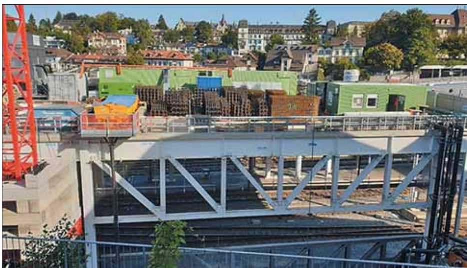
Obr. 5 Zmrazovací zařízení na plošině Fig. 5 Freeze plant on platform
