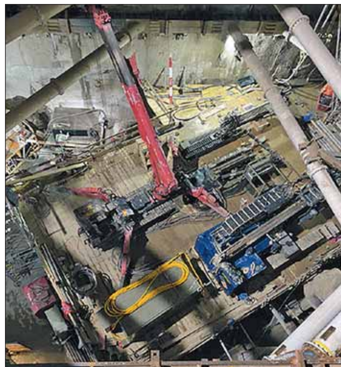
Obr. 2 Vrtná souprava vedle minipásového jeřábu na nosné konstrukci v jámě Fig. 2 Drilling rig next to mini crawler crane on support structure in pit
