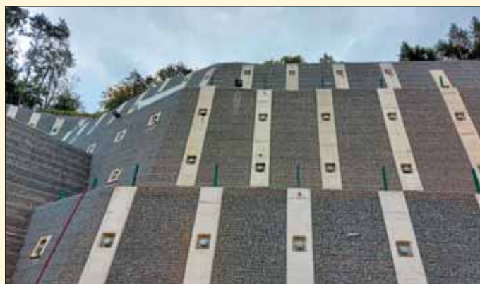
Obr. 10 Konečné terénne úpravy západného portálu tunela Milochov Fig. 10 Final terrain finishes at the western portal of the Milochov tunnel
