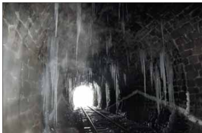
Obr. 5 Zalednění tunelu Fig. 5 Ice in the tunnel
