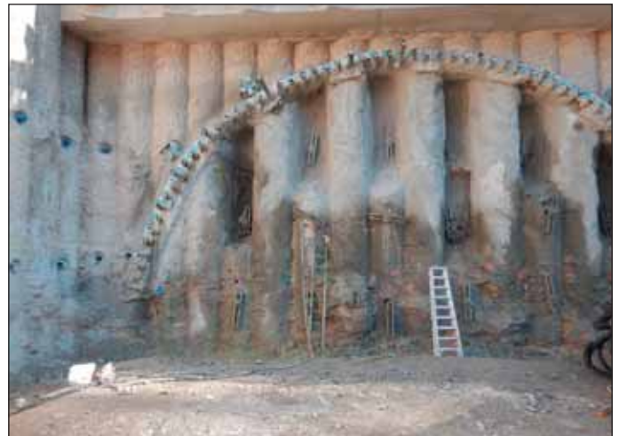
Obr. 8 Jižní portál tunelu, částečně otevřená pilotová stěna s vyznačeným rasterem pro injektáž čelby
