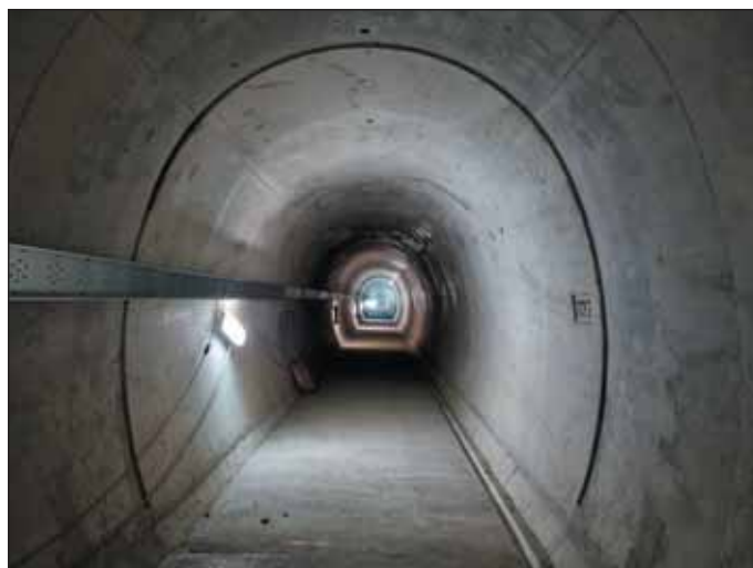
Obr. 11 Hotové betonáže v únikové štole Fig. 11 Finished concretes in the escape gallery
