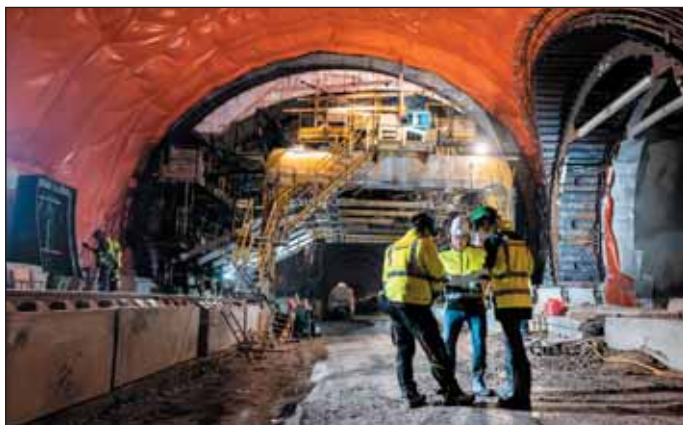
Obr. 5 Príprava debnenia zárodku prejazdného priečneho prepojenia v núdzovom zálive Fig. 5 Preparation of formwork for a stub of cross passage gallery passable for vehicles in the emergency stopping bay
