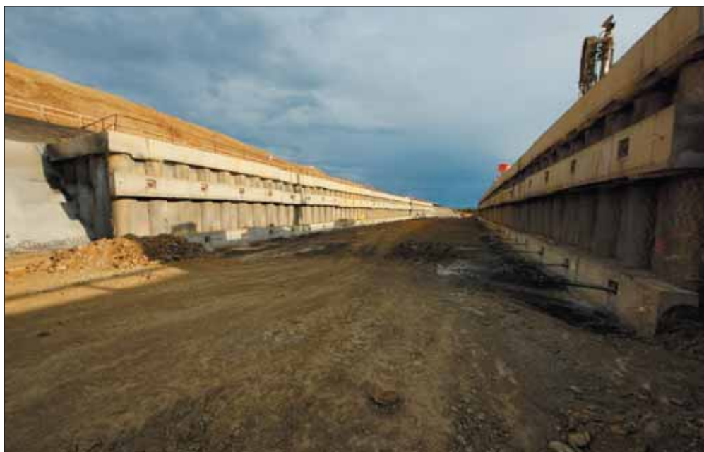
Obr. 4 Odtěžení druhé etáže v prostoru pilotových stěn Fig. 4 Excavation of the second floor in the area of the pile walls
