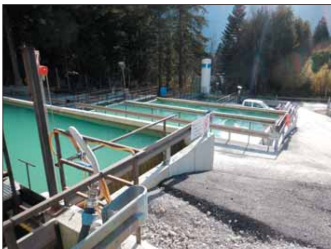
Obr. 6 Jižní portál, sedimentační nádrže a neutralizační stanice Fig. 6 South portal, sedimentation tanks and neutralization station
