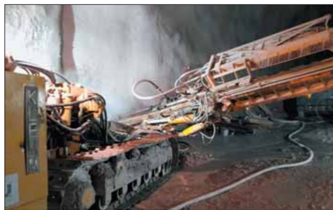
Obr. 4 Realizácia odvodňovacích vrtov do drenážnej štólne Fig. 4 Drilling drainage holes into drainage gallery
