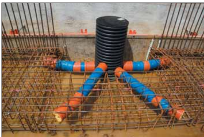
Obr. 8 Vedení drenážního potrubí v patce Fig. 8 Drainage pipe in the foundation strip
