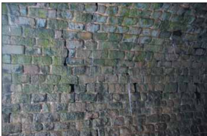
Obr. 4 Trhliny v ostění Fig. 4 Cracks in the lining
