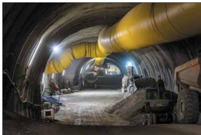
Obr. 13 Rozšíření v nouzovém zálivu PB06 v průběhu tzv. rotující ražby Fig. 13 Widening in the emergency bay PB06 during the so-called rotating excavations
