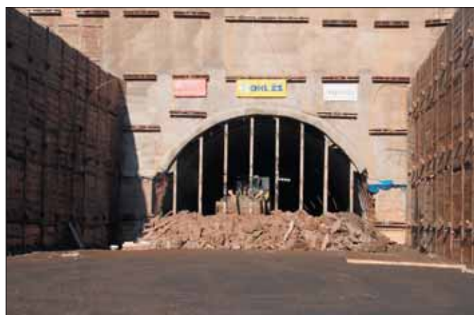
Obr. 4 Prorážka do stavební jámy vjezdového portálu Fig. 4 Breakthrough to construction pit at entrance portal
