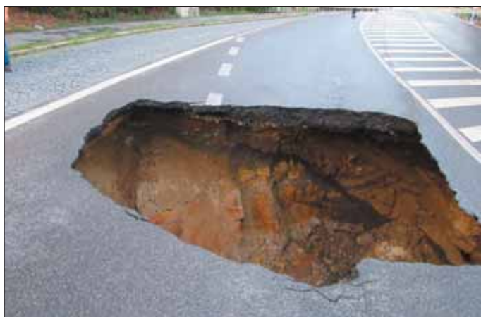
Obr. 1 Propad vozovky při havárii kanalizace v ulici Vysočanská Fig. 1 Sinkhole in roadway at the accident on sewer in Vysočanská Street
