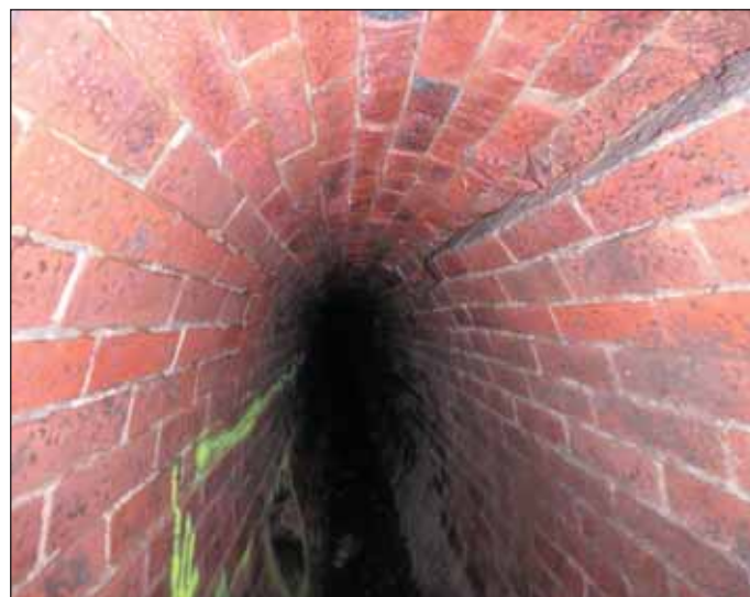
Obr. 9 Příčný posun klenby stoky vlivem vnitřního přetlakového režimu ve stoce a následné svírání profilu Fig. 9 Lateral shifting of the vault due to internal overpressure regime in the sewer and subsequent contraction of the profile
