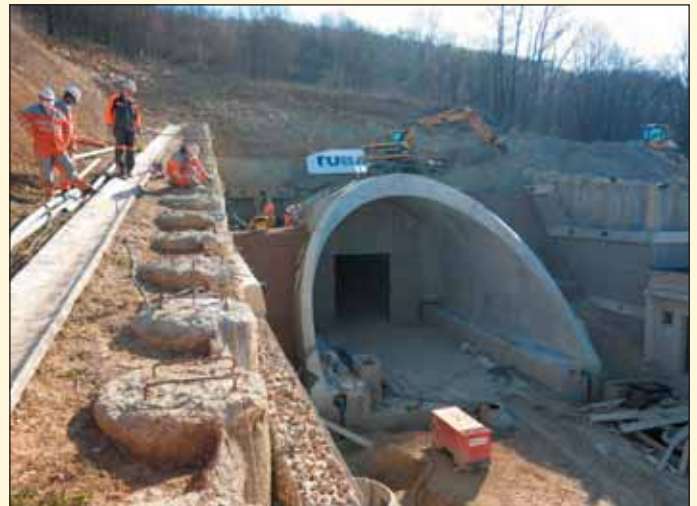
Obr. 6 Konečné terénne úpravy – západný portál, tunel Diel Fig. 6 Final terrain finishes at the WP of the Diel tunnel
