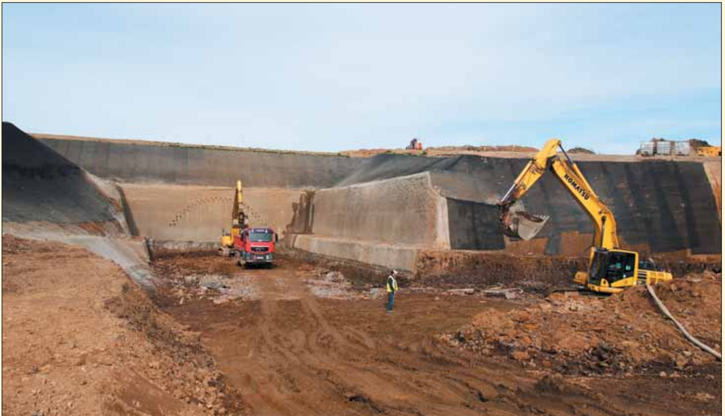
Obr. 4 Hloubení stavební jámy vjezdového portálu Fig. 4 Excavation of construction pit for the entrance portal
