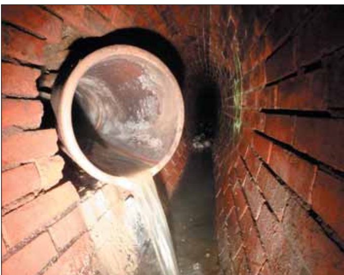
Obr. 6 Nesprávné zaústění (přesazení hrdla) přípojky do stoky s obnažením horninového prostředí za ostěním Fig. 6 Incorrect connection (socket overlapping) of a sewer service into the sewer with exposing the rock environment behind the lining
