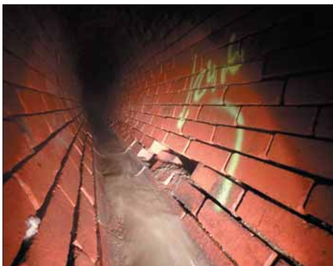
Obr. 2 Chybějící zdivo v blízkosti žlábků stoky Fig. 2 Missing masonry in the vicinity of the sewer flume
