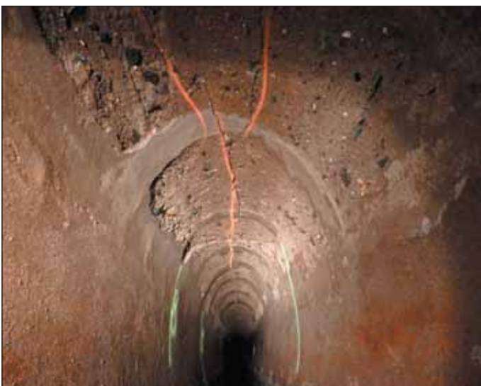
Obr. 10 Trhliny v klenbě způsobené nadměrným zatěžováním nadloží stoky Fig. 10 Cracks in the vault caused by the action of excessive loading on the sewer overburden
