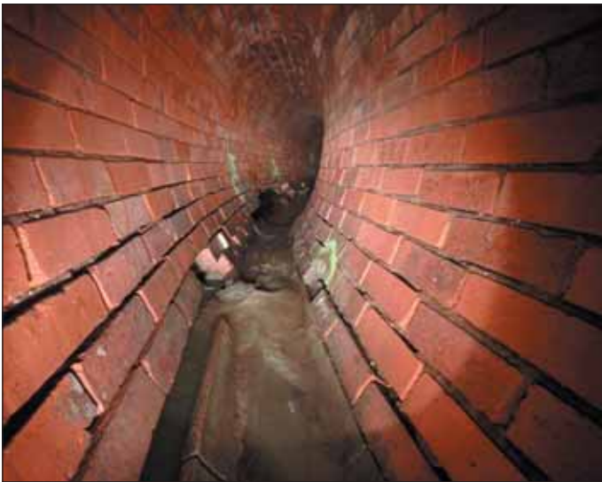
Obr. 4 Rozvolnění řad cihel nad žlábkem a vyplavování zeminového materiálu zpoza ostění stoky Fig. 4 Loosening of a row of bricks above the flume and washing out soil material from behind the sewer lining
