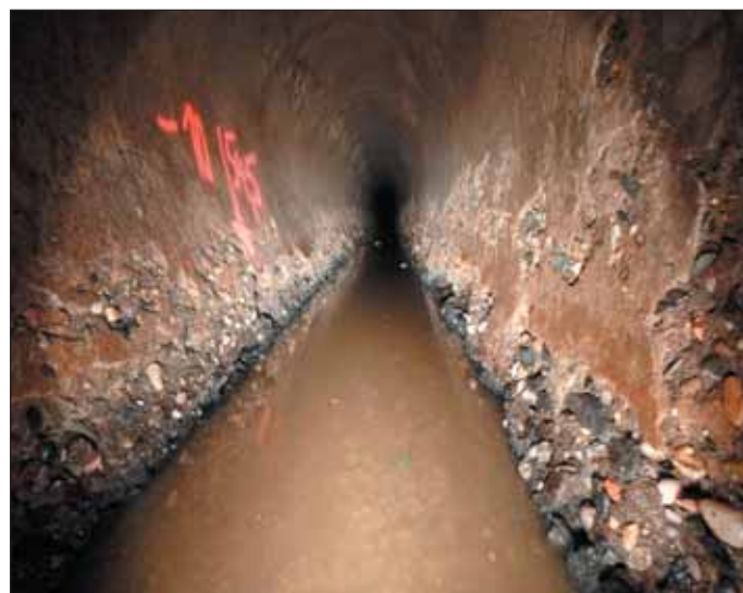
Obr. 3 Degradace betonu stoky – především v její kyneti Fig. 3 Degradation of the sewer concrete – first of all at its cunette
