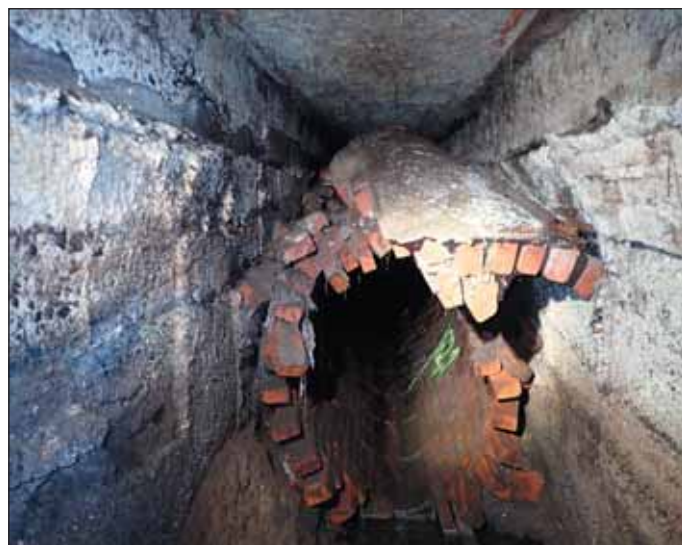
Obr. 11 Porušení celistvosti stoky vedené v betonovém kanálu Fig. 11 Broken integrity of a sewer running inside a concrete channel
