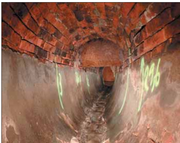
Obr. 8 Zmenšení profilu stoky způsobené křížením s jinou inženýrskou sítí Fig. 8 Reduction of the sewer profile caused by crossing with another network
