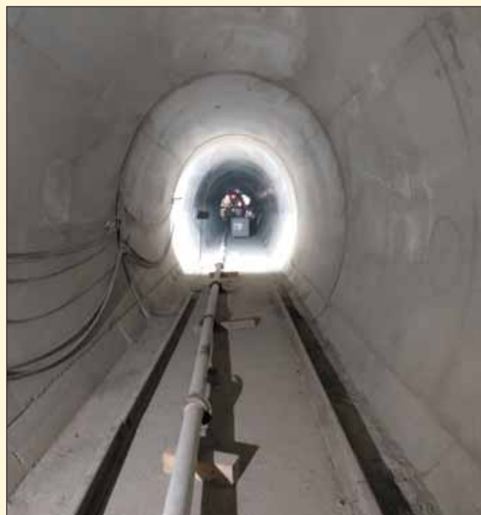
Obr. 6 Betonáž sekundárneho ostenia únikovej štôľne Diel Fig. 6 Concreting the secondary lining in the escape gallery of the Diel tunnel
