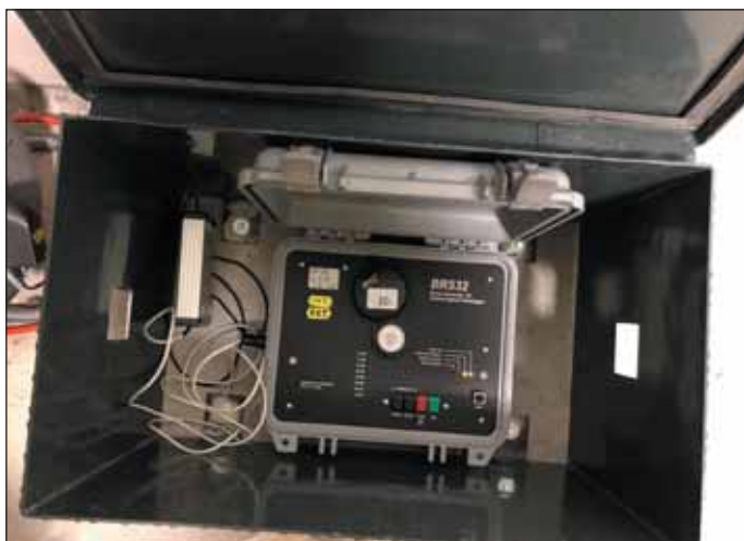
Obr. 14 Měřicí aparatura k průběžnému monitorování veškerých otřesů a vibrací
