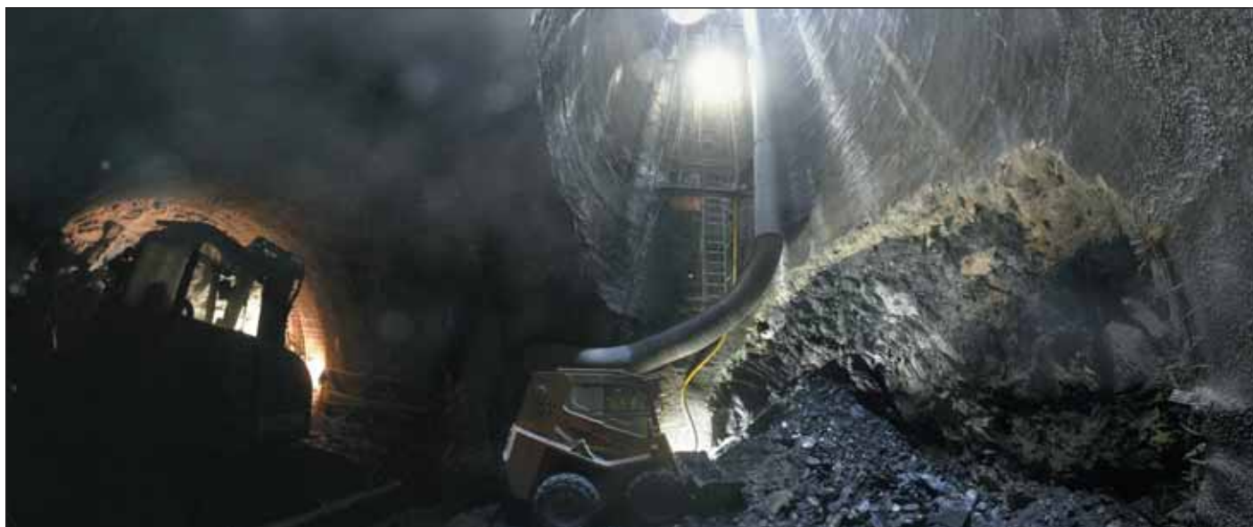
Obr. 2 Panoramatická fotografie ze dna šachty Š1 Fig. 2 Panoramic photo from shaft Š1 bottom
