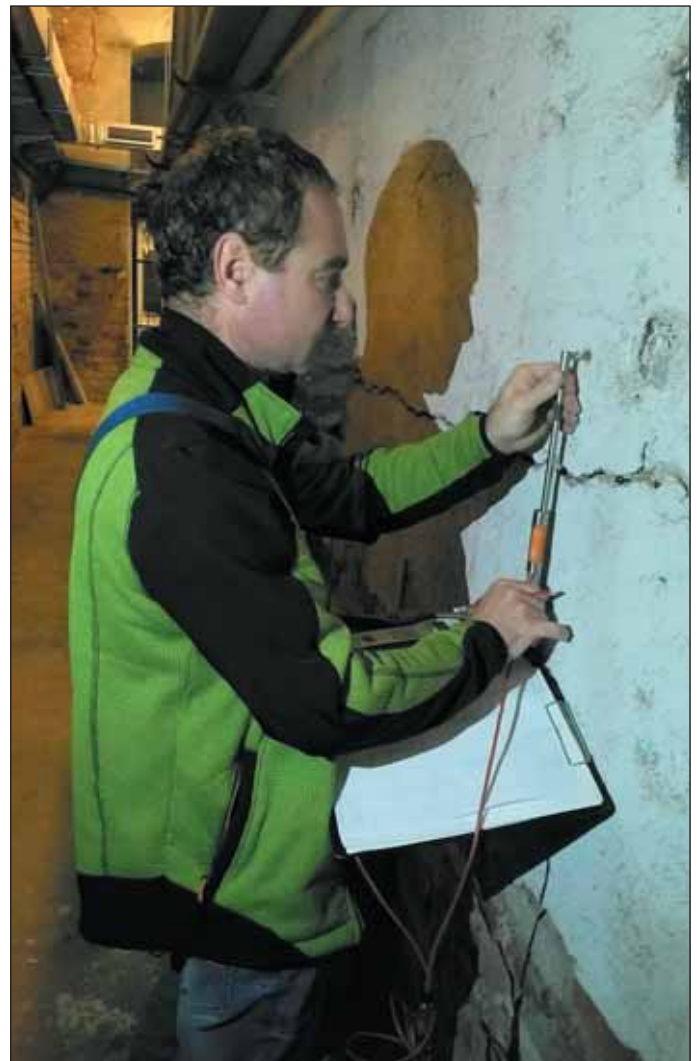
Obr. 12 Měření na trhlínách objektu Trojanova 339/13 – Jaderná fakulta ČVUT
