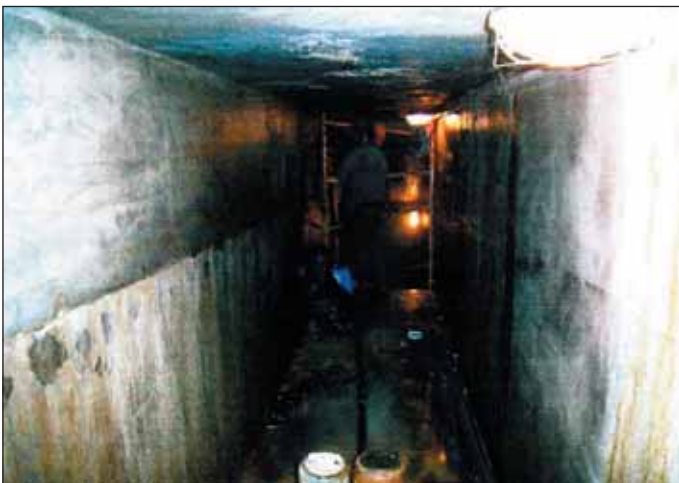
Obr. 8 Pronikání vody do vnitřního prostoru přístupu do kompresorovny Fig. 8 Intrusion of water into the internal space of the access to the compressor station
