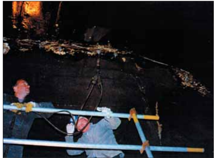
Obr. 7 Utěsnění liniového průsaku Fig. 7 Sealing of linear leak
