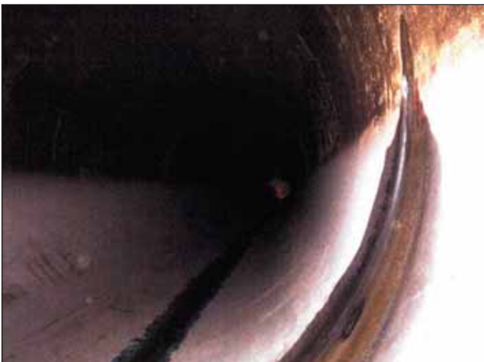
Obr. 2 Voda pronikající přes zátku Fig. 2 Water leaking through a plug
