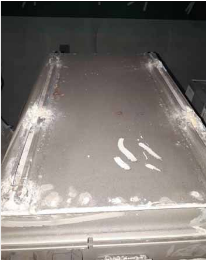
Obr. 2 Detail degradace demontovaného osvětlení Fig. 2 Detail of degradation of the disassembled lighting
