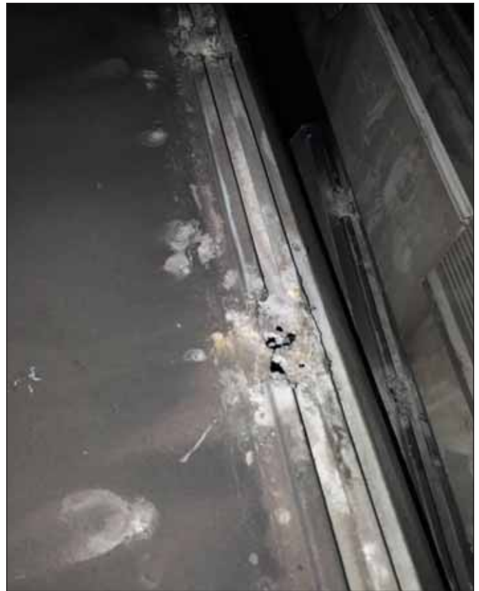
Obr. 3 Detail degradace demontovaného osvětlení Fig. 3 Detail of degradation of the disassembled lighting
