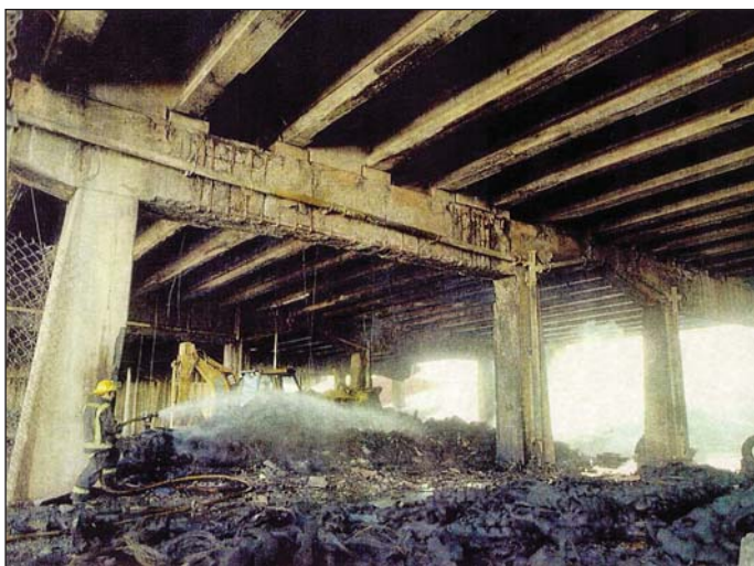
Obr. 4 Oprýskání betonu až na nosnou výztuž
