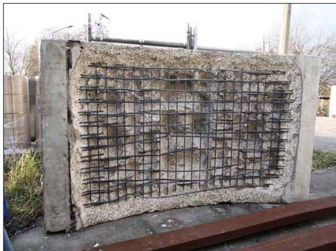
Obr. 3 Ukázka odprýskaného betonu až po ocelovou výztuž
