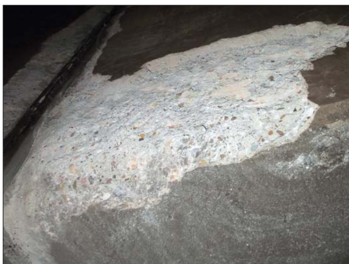
Obr. 10 Poškození betonu požárem
