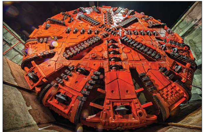
Obr. 10 Tunel Ejovice – pohled na připravenou řeznou hlavu ve startovacím lůžku Fig. 10 Ejovice tunnel – a view of the cutterhead prepared on the launch cradle
