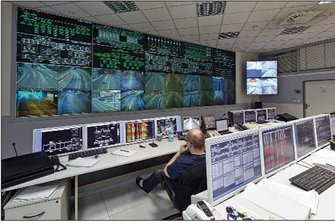
Obr. 7 Dispečink tunelů na Strahově Fig. 7 Traffic management centre in Strahov
