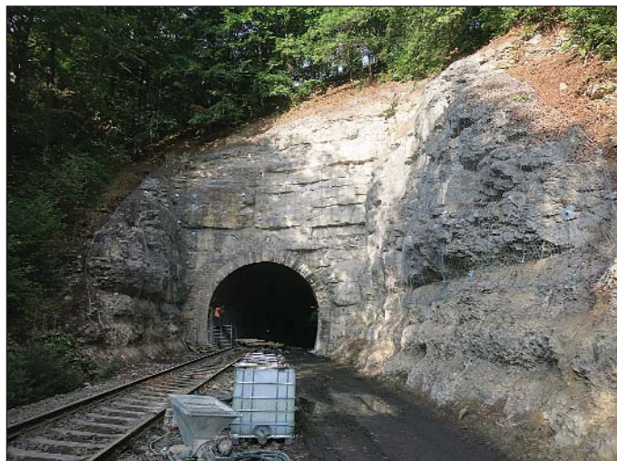
Obr. 10 Východní portál a příportálový úsek tunelu zajištěné přikotvenou dvouzávitovou drátěnou sítí Maccafferri
