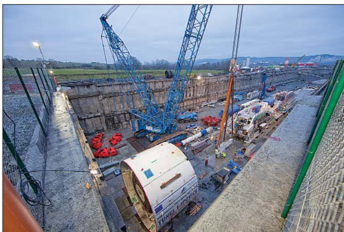
Obr. 5 Montáž tunelovacího stroje S-799 před východní portálovou stěnou Fig. 5 Assembly of the S-799 TBM in front of the eastern portal wall
