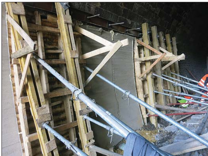
Obr. 8 Nově betonované pruhy ostění, příložné bednění se vzpěrami, hotová betonová opěra po odbednění v pásu č. TP6
