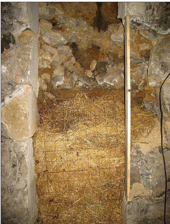
Obr. 6 Slámová drenážní vrstva s výztužnou a přidržnou KARI sítí Fig. 6 Straw drainage layer with the reinforcing and holding KARI mesh
