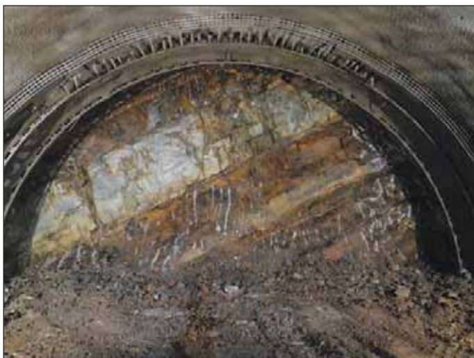
Obr. 12 Deštník ze svorníků IBO R51 L (foto Lukáš Kuča) Fig. 12 Protective umbrella - IBO R51 L rock bolts (photo Lukáš Kuča)
