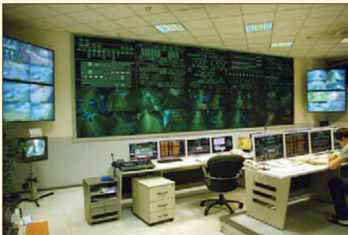
Obr. 1 Velín SAT, po stranách jsou vidět 4 nově instalované monitory určené pro zobrazení signálů kamerového dohledu tunelových staveb
