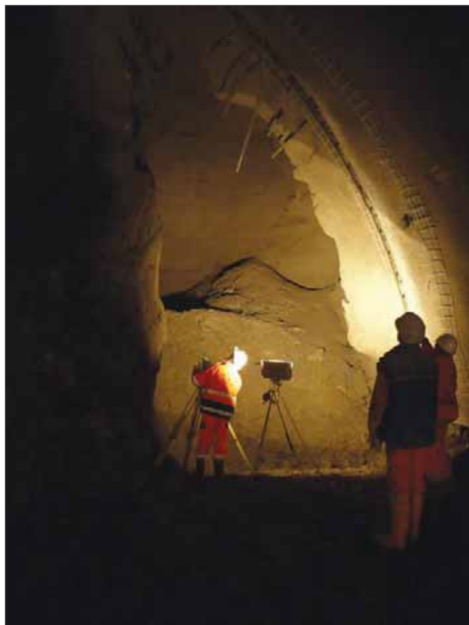
Obr. 7 Zaměřování kaverny ve staničení 580,01 (Zdroj: BeMo, 2010b) Fig. 7 Surveying the void at TM 580.01 (Source: BeMo, 2010b)
