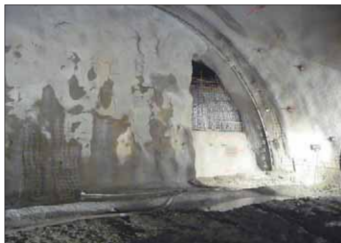
Obr. 9 Uzavírání vstupu do kaverny ve staničení 580,01 (Zdroj: BeMo, 2010b) Fig. 9 Closing the void at TM 580.01 (Source: BeMo, 2010b)
