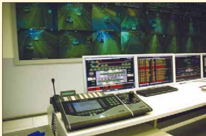
Obr. 2 Ovládací pult kamerového systému Fig. 2 Control panel of the camera system
