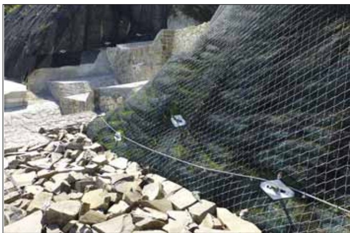
Obr. 4 Zpevněný odvodňovací žlab Fig. 4 The paved drainage trough
