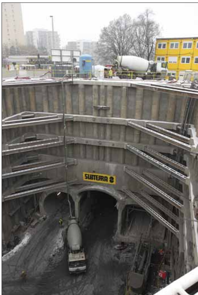
Obr. 1 Přecerpávání betonu z terénu do automixu na dně stavební jámy Fig. 1 Re-pumping concrete from terrain surface to a mix truck at the construction pit bottom
