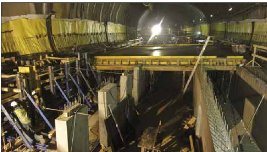
Obr. 5 Pohled na VZT kanál (zdroj: Archiv SMP CZ, a.s.)
