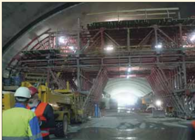
Obr. 6 Bednění PERI použité pro betonáž klenby kaverny Fig. 6 PERI formwork used for the casting of the cavern vault
