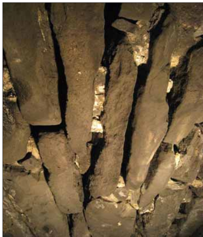
Obr. 3 Poruchy spárování v klenbě Domašovského tunelu Fig. 3 Defects of jointing in the Domašov tunnel arch
