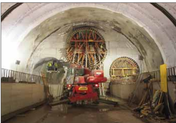
Obr. 5 Pohled ze stanice Bořislavka na střední eskalátorový a traťové tunely (foto Ing. Jiří Junek)
