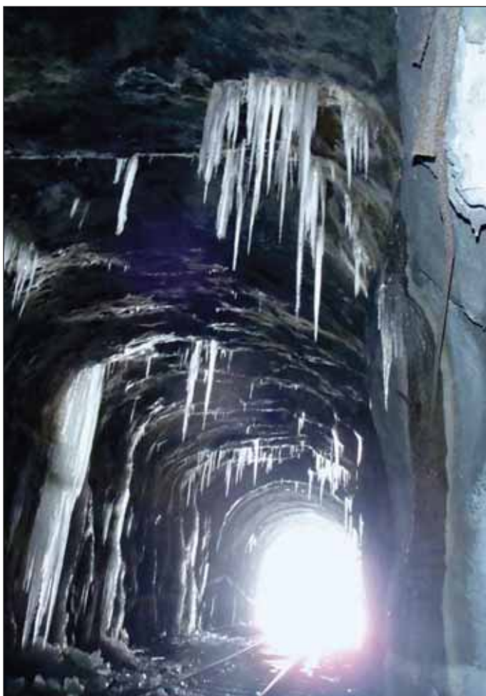
Obr. 10 Stav Jívovského tunelu v zimním období Fig. 10 Jívová tunnel condition during winter season
