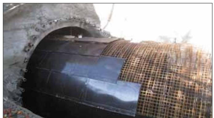
Obr. 8 Výztuž ostění Domašovského tunelu s ochranou proti zemní vlhkosti Fig. 8 Reinforcement of the Domašov tunnel lining with damp proofing
