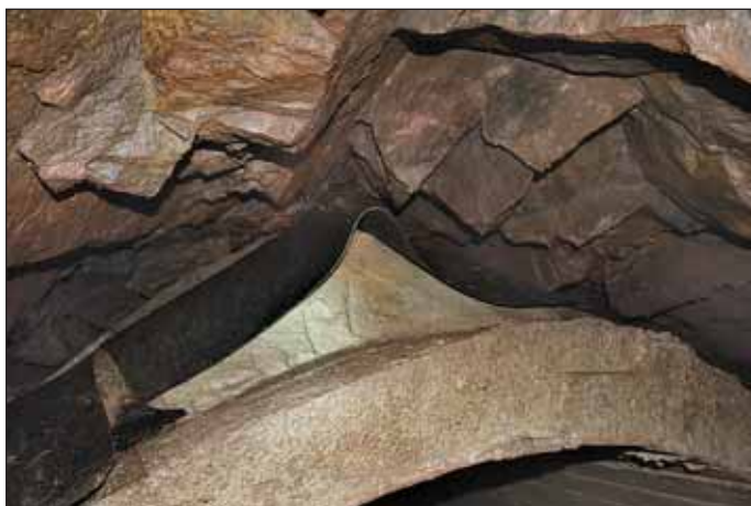
Obr. 18 Betonový „hřeben“ s izolací z lepenkových pásů na klenbě ostění hlavní galerie tvrze Dobrošov
