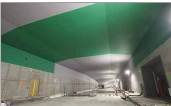
Obr. 13 Nátěr klenby v hloubeném tunelu na Letné Fig. 13 Coating applied to the vault of the Letná cut-and-cover tunnel
