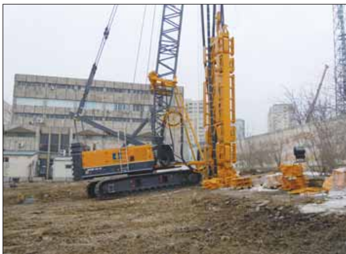
Obr. 8 Provádění podzemních stěn pomocí hydrofrézy Fig. 8 Installation of diaphragm walls by means of a hydro-cutter
