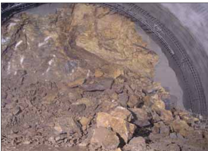
Obr. 1 Vypadnutí části čelby v TM 147,9 (RNDr. P. Novotný) Fig. 1 Collapse of a part of the excavation face at tunnel chainage m 147.9 (RNDr. P. Novotný)
