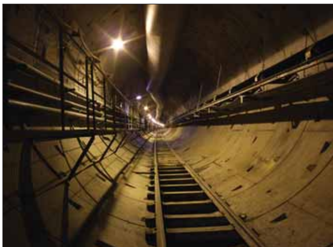
Obr. 3 Pohled do západní tunelové trouby Fig. 3 A view down the western tunnel tube
