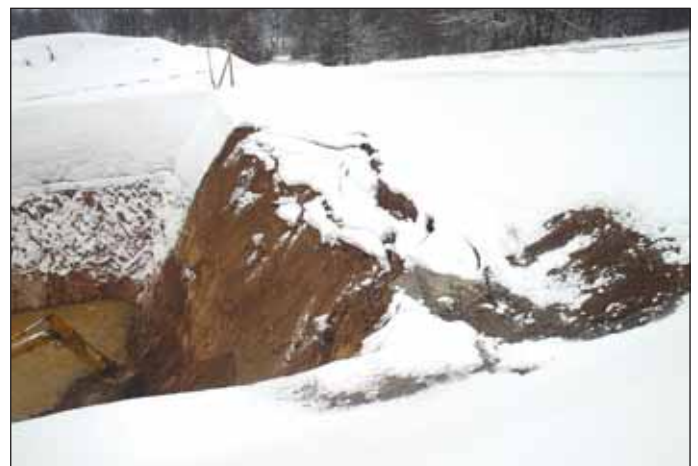
Obr. 9 Zátrh výjezdového portálu tunelu Tomický II po predisponované ploše Fig. 9 Slide scar at the Tomice No. 2 tunnel exit portal (sliding along a pre-disposed surface)
