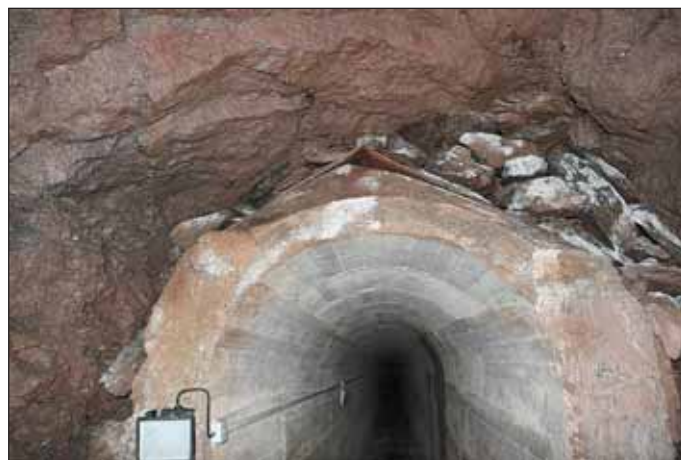
Obr. 19 Izolace klenby ostění s použitím střežovitého plechu na betonovém „hřebenu“ u hlavní galerie tvrze Dobrošov
