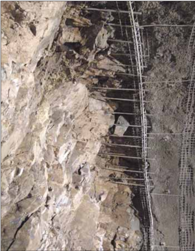
Obr. 7 Přístropí silně postižené diskontinuitami se zajištěním ocelovými jehlami – Tunel Tomický II (RNDr. E. Straka)
