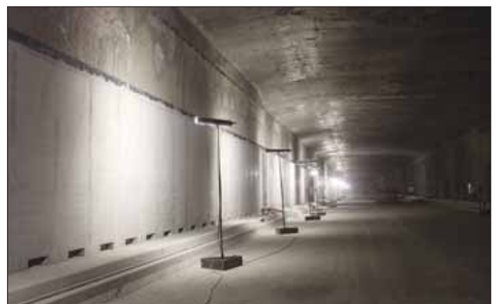
Obr. 14 Finální povrchová úprava milánských stěn v tunelech u Špejcharu Fig. 14 Final work of a Špejchar tunnel diaphragm walls
