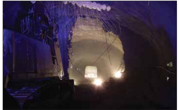
Obr. 2 Expresivní foto z prorážky tratových tunelů ražených NRTM v úseku Motol - Vypich (foto: Ing. Libor Mařík) Fig. 2 Expressive picture from the breakthrough of running tunnels driven using the NATM in the Motol - Vypich section (Photo courtesy of Ing. Libor Mařík)
