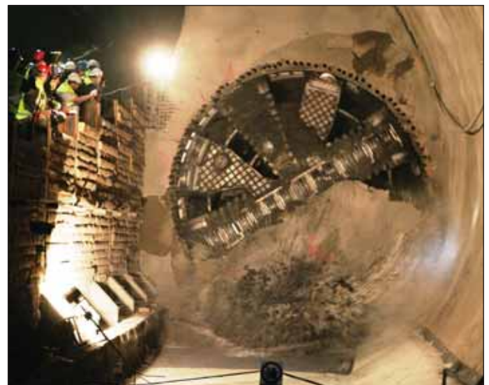
Obr. 6 Účastníci slavnostní prorážky sledují průnik štítu Tonda do stanice Červený vrch Fig. 6 Attendees of the breakthrough celebration follow the penetration of the Tonda shield into the Červený Vrch station
