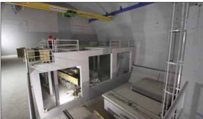
Obr. 11 Jeden z prostorů pro hlavní ventilátory v ražené strojovně vzduchotechniky Fig. 11 One of the spaces for main fans in the mined cavern for the ventilation plant
