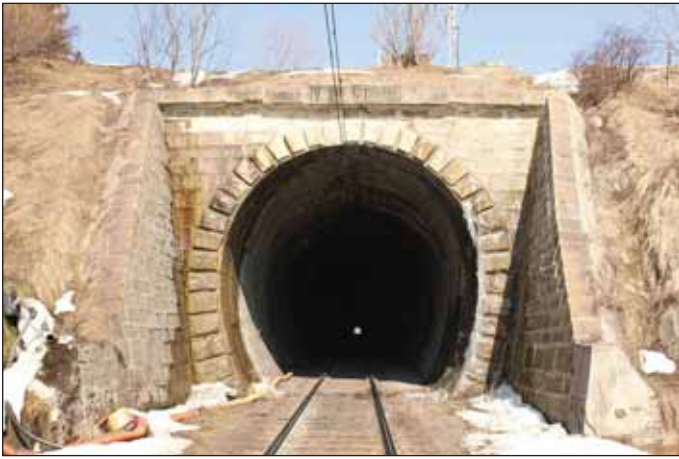
Obr. 2 Jižní portál tunelu Jablunkov č. I Fig. 2 Southern portal of the Jablunkov No. 1 tunnel
