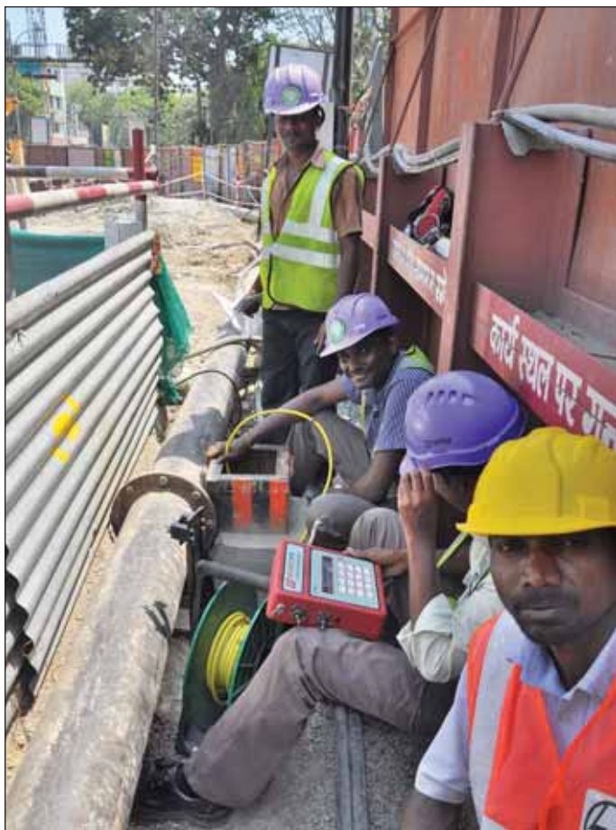
Obr. 4 Inklinometrické měření v konstrukci podzemní železobetonové stěny Fig. 4 Inclinometer measurement in a reinforced concrete diaphragm wall structure
