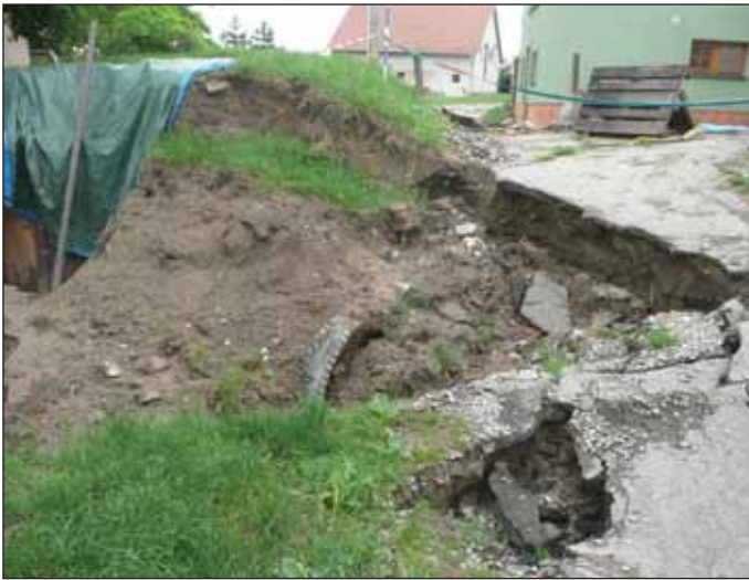
Obr. 6 Popice (u Hustopeč u Brna), rok 2010; zával starého vinného sklepa v místní komunikaci, příčinou bylo zanedbání údržby konstrukce sklepa a přetěžování místní komunikace
