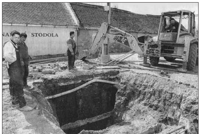
Obr. 5 Šatov, rok 2004 – zával v místní komunikaci do Moravského sklípku; porucha byla způsobena přetěžováním místní komunikace [7]
