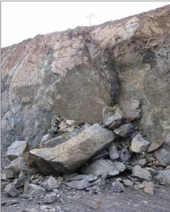
Obr. 2 Uvolněné skalní bloky (04/2010) Fig. 2 Loosened rock blocks (04/2010)
