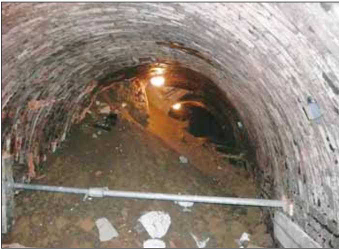
Obr. 8 Bořetice – Kraví hora, leden 2009 – částečně zavalený sklep p. Václava Bukovského; vlevo od závalového kužele je patrné porušení vyzdívky, v pravé patě závalu jsou uvízlé sudy s vínem
