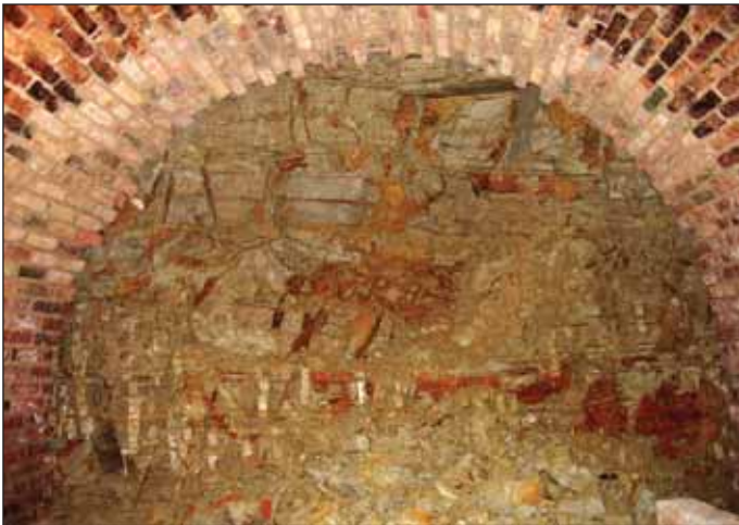
Obr. 3 Perná u Mikulova; „Kvelbení“ s výstavbou obezdívky tunelářským způsobem, patrný je nově vyzděný pas, tloušťka obezdívky na 1 cihlu = 15 cm, obnažená čelba s dobře patrnými paleogenními vrstvami, ražba a zdění prováděny v prodloužení existujícího sklepa v nevelké hloubce pod místní komunikací, prakticky bez jakéhokoliv zabezpečení
