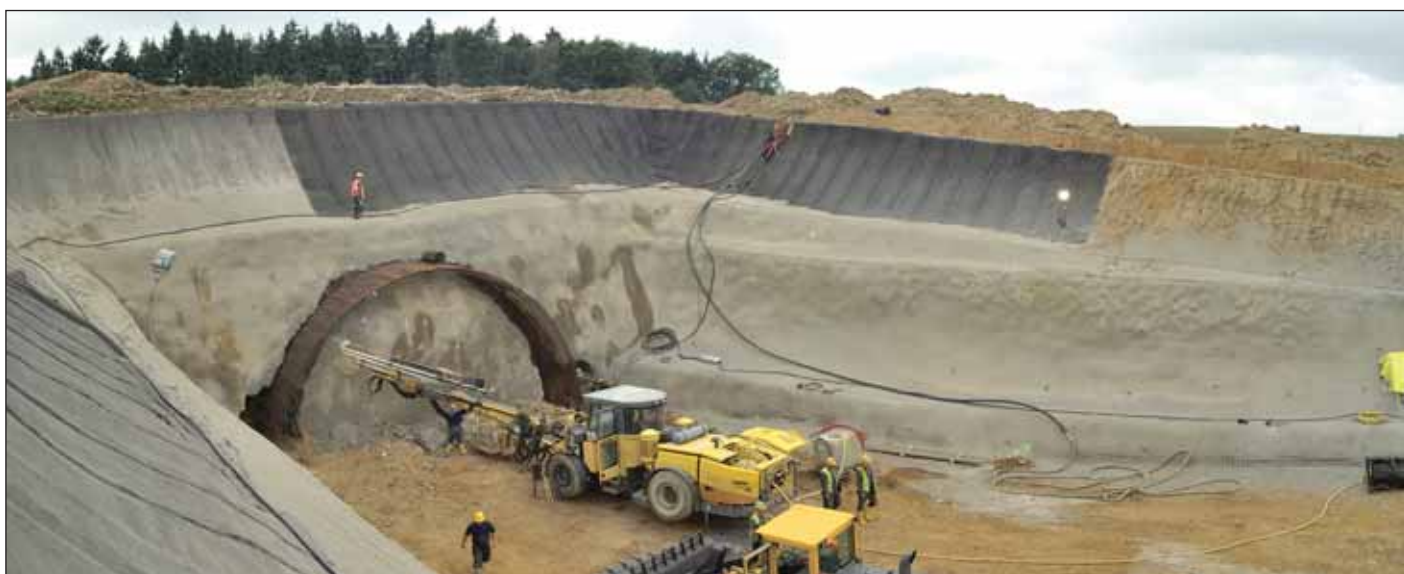
Obr. 12 Stavba zárodku kaloty v jámě Tomického tunelu I. Fig. 12 Construction of the starting top heading stub in the construction pit for the Tomice tunnel I.
