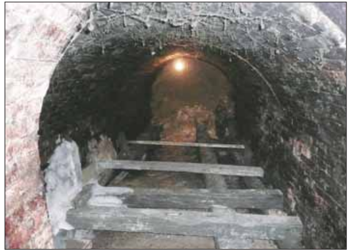
Obr. 10 Bořetice – Kraví hora, leden 2009; jeden ze sklepů bezprostředně vlevo zříceného sklepa, zavalené čelo a boulení vyzdívky v patě opěří, rozpěrná výdřeva je nahnílá a postižená plísní
