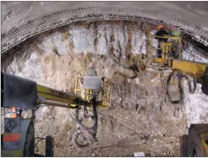
Obr. 8 Tryskové injektáže v čelbě tunelu při zmáhání závalu Fig. 8 Jet grouting at the tunnel excavation face during the passage through the collapse
