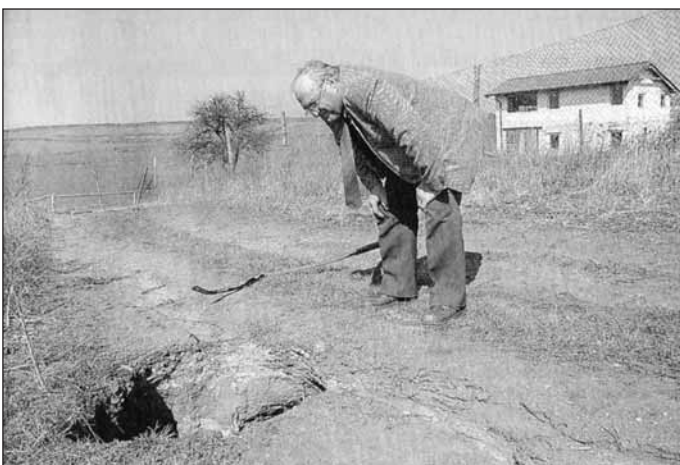
Obr. 4 Nový Šaldorf, rok 2004 – porucha v místní komunikaci nad vinnými sklepy; porucha byla způsobena nedostatečnou údržbou konstrukce sklepa a přetěžováním místní komunikace [7]
