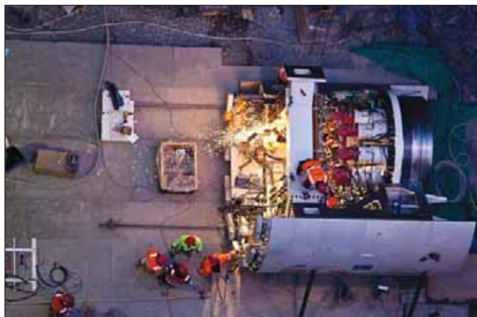
Obr. 6 Vrchní pohled na štítovou část stroje S-609 během montáže (foto Jan Tatar) Fig. 6 View of the top of the shield part of S-609 tunnelling complex during assembly (Photo courtesy of Jan Tatar)
