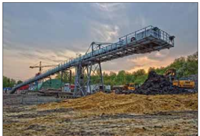
Obr. 12 Dopravníkové pásy od zeminových štítů s mezideponií rubaniny (foto J. Tatar) Fig. 12 Belt conveyors running from EPB shields and the muck stockpile (photo courtesy of J. Tatar)
