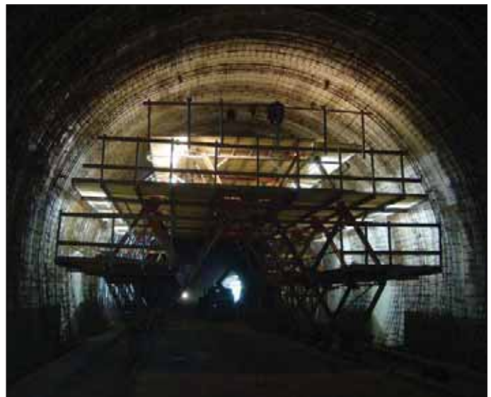
Obr. 4 Montáž výztuže definitivního ostění z armovacího vozíku Fig. 4 Installation of the final lining reinforcement from a travelling scaffold
