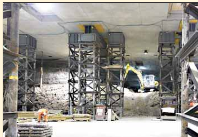
Obr. 3 Foto z exkurze – okruh A (Zürich): Předstihové zřízení svislých nosných prvků pro podzemní prostory – mikropilotové bárky Fig. 3 Photography from the excursion to the A Ring Road (Zurich): Micropile trestles - vertical load-bearing elements for underground spaces prepared in advance
