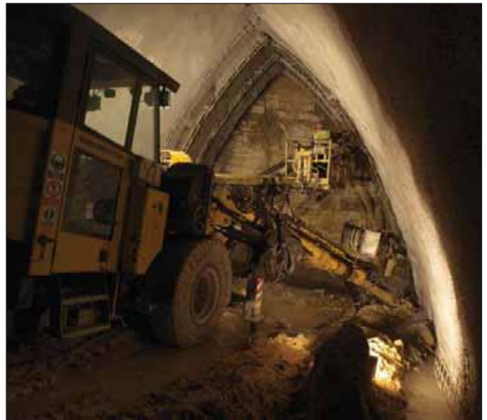
Obr. 8 Provádění primárního ostění pravého dílčího výrubu stanice Petřiny (foto J. Junek) Fig. 8 Installation of primary lining of the right-hand partial drift for Petřiny station (photo courtesy of J. Junek)
