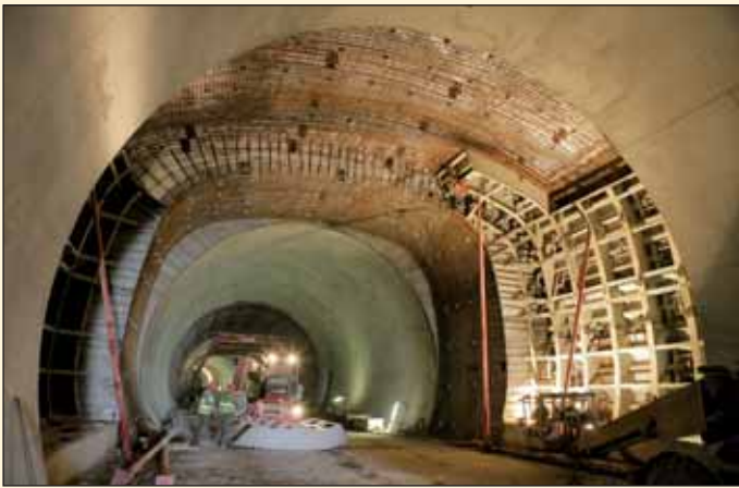
Obr. 1 Bednění a výztuž napínacího výklenku v tunelech Nového spojení Fig. 1 Formwork and reinforcement for a traction tensioning chamber in the tunnels of the New Connection Project
