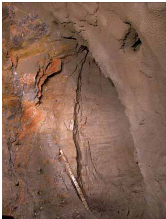
Obr. 4 Kaverna zastížená ve staničení km 25+261 Fig. 4 The cavern encountered at chainage km 25+261
