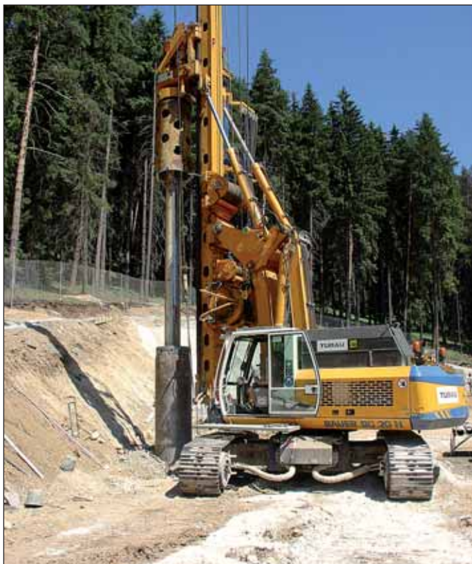
Obr. 1 Vrtanie pilotovej steny v úseku západného portálu Fig. 1 Drilling for the pile wall in the western portal section
