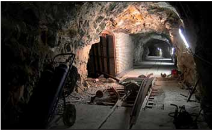
Obr. 3 Odbočení k akumulátorovně, stav před dokončením Fig. 3 Turning to battery charging station, situation before finishing
