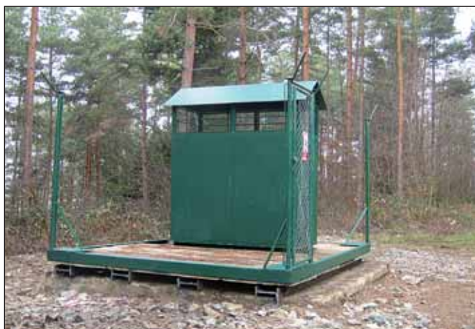
Obr. 8 Větrací objekt na ohlubní větracího komínu Fig. 8 Ventilation unit on vent shaft pit bank
