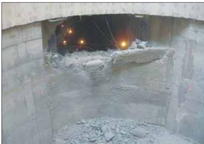
Foto 6 Počátek prorážky tunelu do šachty Photo 6 Start of the piles demolition for the tunnel opening
