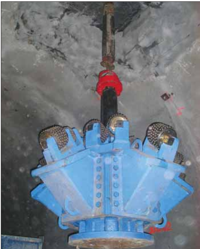
Obr. 1 Usazené rozšiřovací těleso v tunelové spoje Fig. 1 The back-reaming head installed in the cross passage
