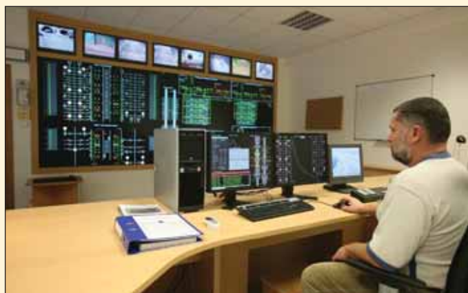
Obr. 8 Řídicí středisko ŘSD v Řehlovicích Fig. 8 The Directorate of Roads and Motorways' management centre in Řehlovice
