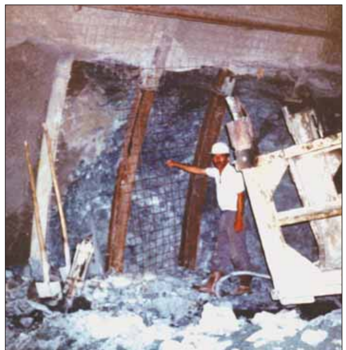
Obr. 1 Úprava profilu v problémovém úseku erenlerských souvrství Fig. 1 The reshaping processes in problematic section of the Erenler Formation
