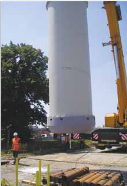
Obr. 4 Roura číslo jedna s naváděcím prstencem připravena k usazování Fig. 4 The pipe No. 1 with the guide ring ready for installation
