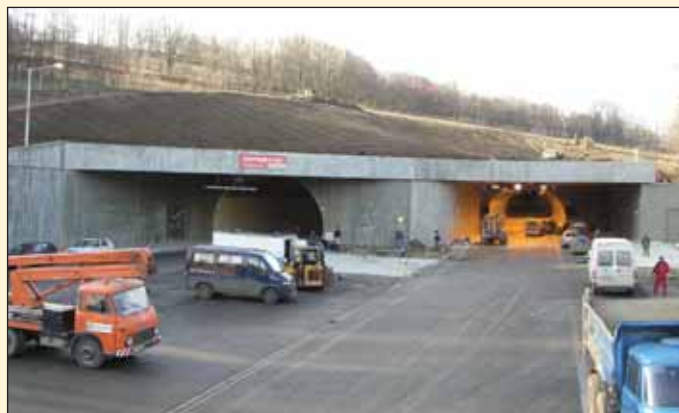
Obr. 6 Dokončovací práce u severního portálu tunelu Panenská Fig. 6 Finishing work at the northern portal of the Panenská tunnel
