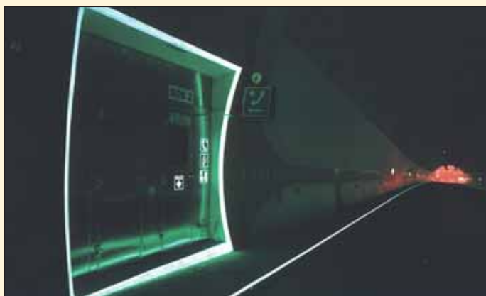
Obr. 5 Nouzové osvětlení a luminiscenční pásy u skříně SOS Fig. 5 Emergency lighting and luminescent strips at the SOS box
