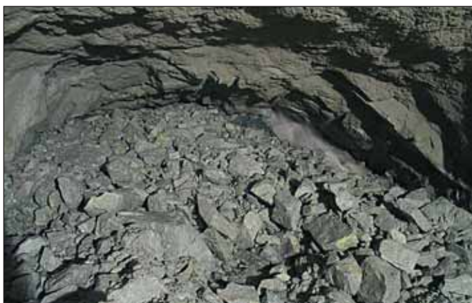
Obr. 5 Zával v úseku razenom technológiou NRTM v staničení 2900,0 m, na rozhraní blokov Z32 a Z33/1, po prívale podzemnej vody
