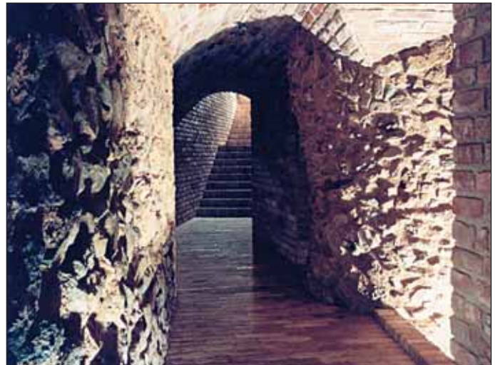
Obr. 5 Mincmistrovský sklep, vstupní chodba po dokončení sanace Fig. 5 Master of mint's cellar; the entrance corridor after completion
