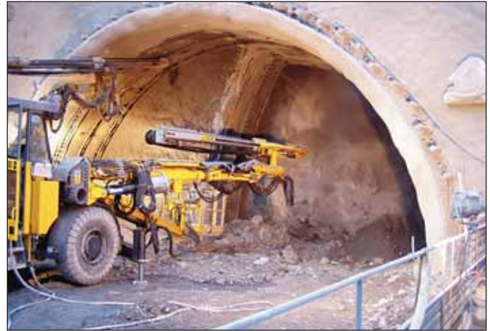
Obr. 3 Vertikální členění kaloty STT Fig. 3 Vertical division of the NTT top heading
