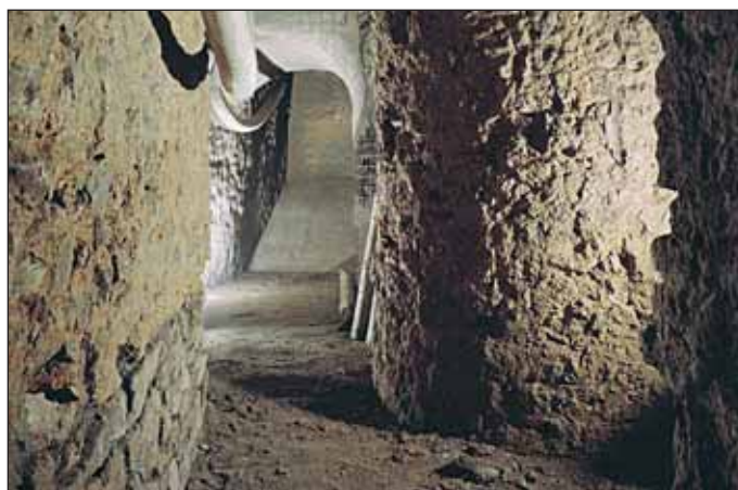
Obr. 4 Mincmistrovský sklep, vstupní chodba před dokončením sanace Fig. 4 Master of mint's cellar; the entrance corridor before completion
