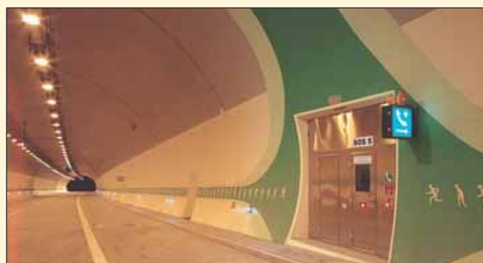
Obr. 4 Pohled na SOS výklenek a bezpečnostní prvky na ostění tunelu Fig. 4 A view of an SOS niche and safety elements on the tunnel lining
