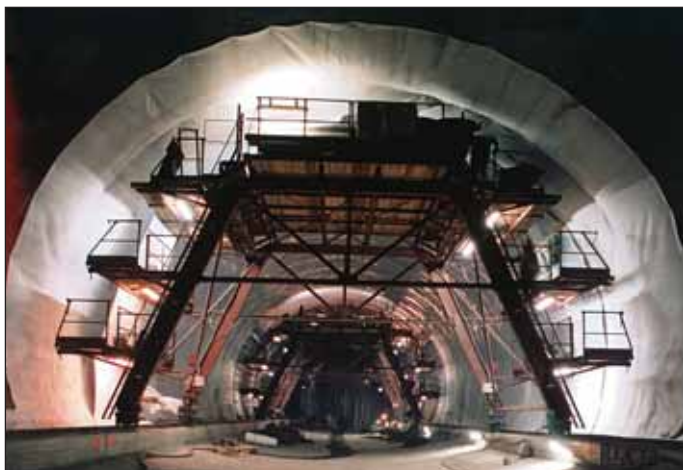
Obr. 1 Pohled na pojízdné plošiny pro montáž izolace a výztuže Fig. 1 A view of the movable platform for installation of the waterproofing and reinforcement
