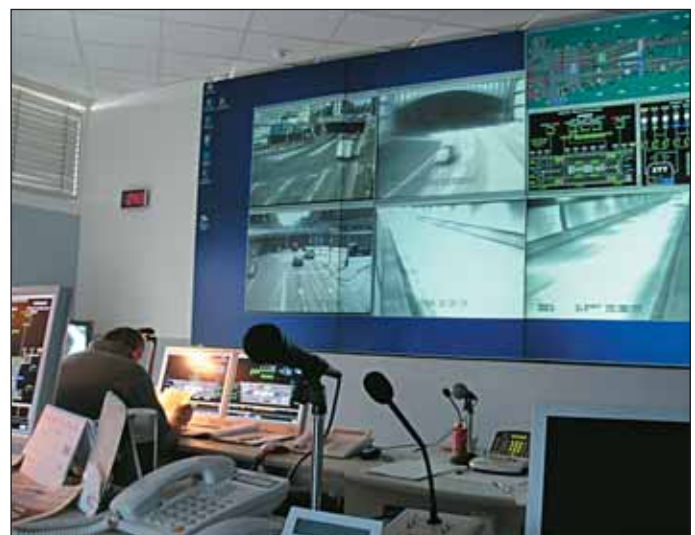
Obr. 4 Centrální velín řízení tunelů v Praze Fig. 4 Tunnel technical services management centre in Prague
