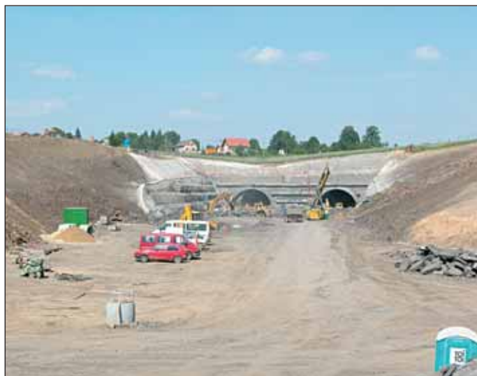
Obr. 2 Portálová část tunelu Klimkovice Fig. 2 The portal portion of the Klimkovice tunnel
