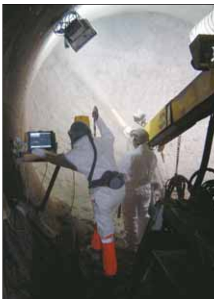
Obr. 3 Inženýr směny používající TunnelBeamer™ pro navádění operátora trysky Fig. 3 Shift engineer using the TunnelBeamer™ to direct a nozzleman
