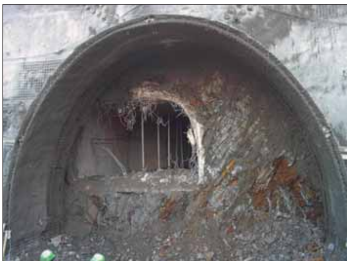
Obr. 3 Zahájení ražby pro střední pilíř tunelu Fig. 3 Starting the excavation of the central tunnel
