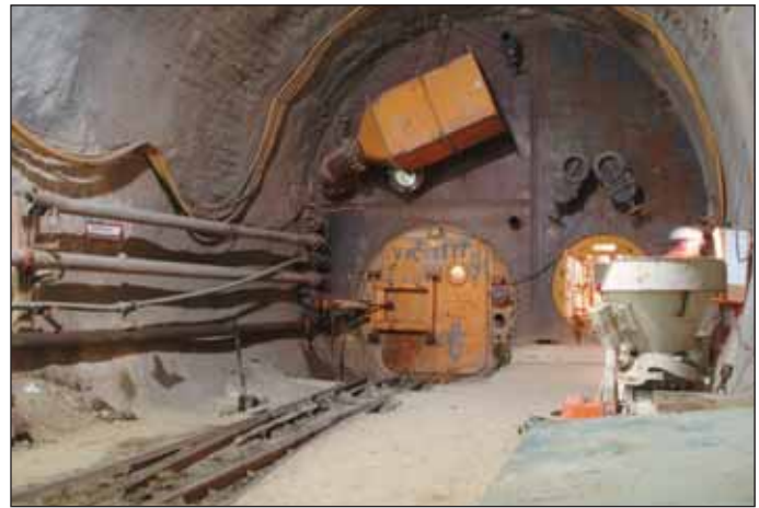
Obr. 3 Oceľová tlaková stena s materiálovou a personálnou komorou Fig. 3 Steel bulkhead with the material and personnel chambers
