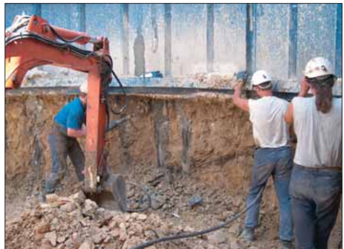
Obr. 6 Pohled na zpevněný bok jámy Fig. 6 View of reinforced side of the shaft
