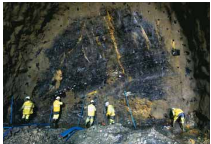
Obr. 7 Nabíjení vrtů při ražbě plným profilem Fig. 7 Charging explosives in full section excavation
