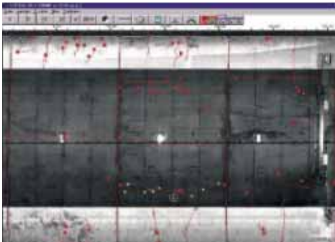
Obr. 2 Zobrazení povrchu tunelu s vyznačenými prasklinami Fig. 2 Tunnel surface map with marked fissures
