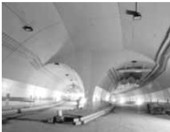
Obr. 11 Silniční tunel Mrázovka na Městském okruhu v Praze na Smíchově Fig. 11 Road tunnel Mrázovka on the Prague city ring road in Smíchov
