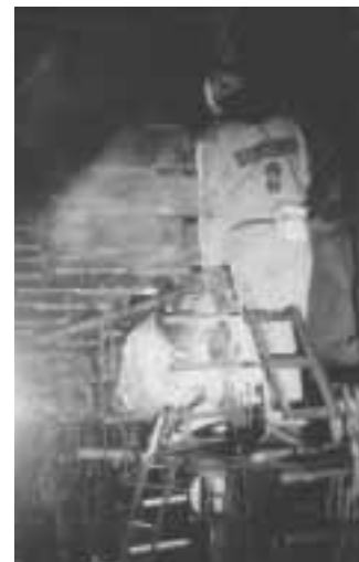
Obr. 8 Kolektor Centrum I. (II. kategorie) Fig. 8 Collector Centrum I. (II. category)
