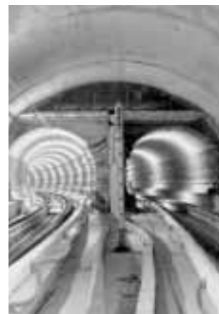
Obr. 13 Rozplet tunelu metra trasy IV C1 v úseku Trója - Kobylisy / Fig. 13 Bifurcation chamber on the subway tunnel IV. C1 in section Trója - Kobylisy
