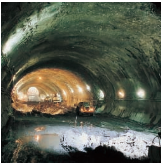
Obr. 7 Dobírání dna a uzavírání ostění jednoklenbové stanice Fig. 7 Bottom excavation and closing of the invert
