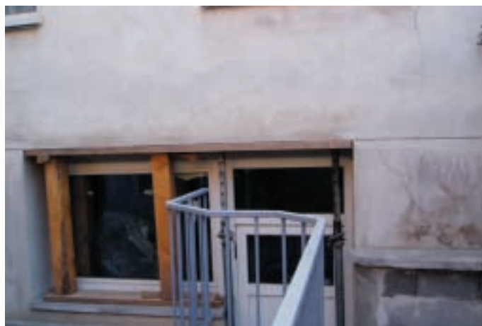
Obr. 5 Příklad trhliny na fasádové zdi Fig. 5 Example of a crack in a front wall
