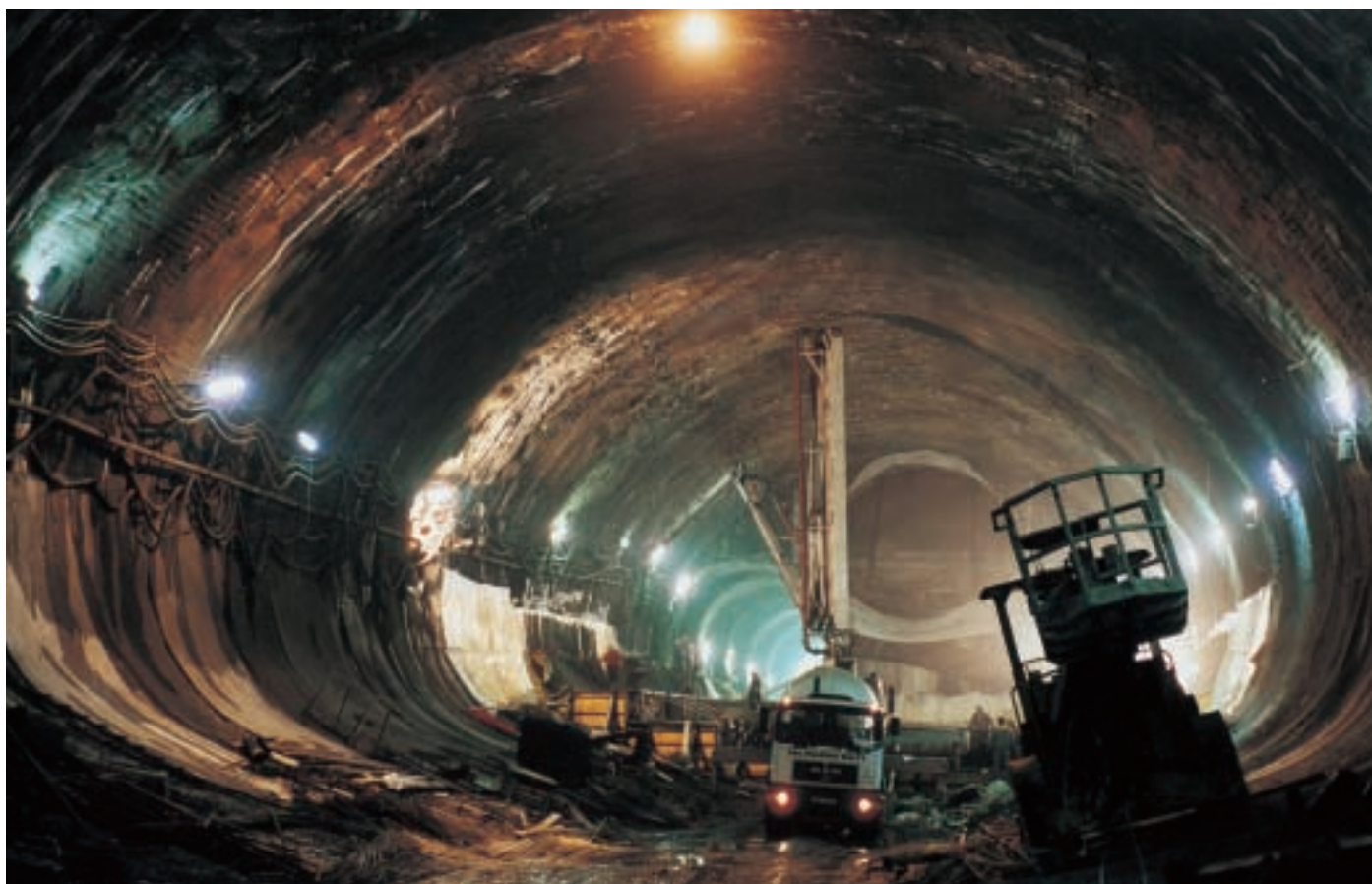
Obr. 9 Zahájení izolačních, armovacích a betonářských prací ve dně stanice Fig. 9 Beginning of waterproofing and reinforcement placing and concrete casting work at the station bottom
