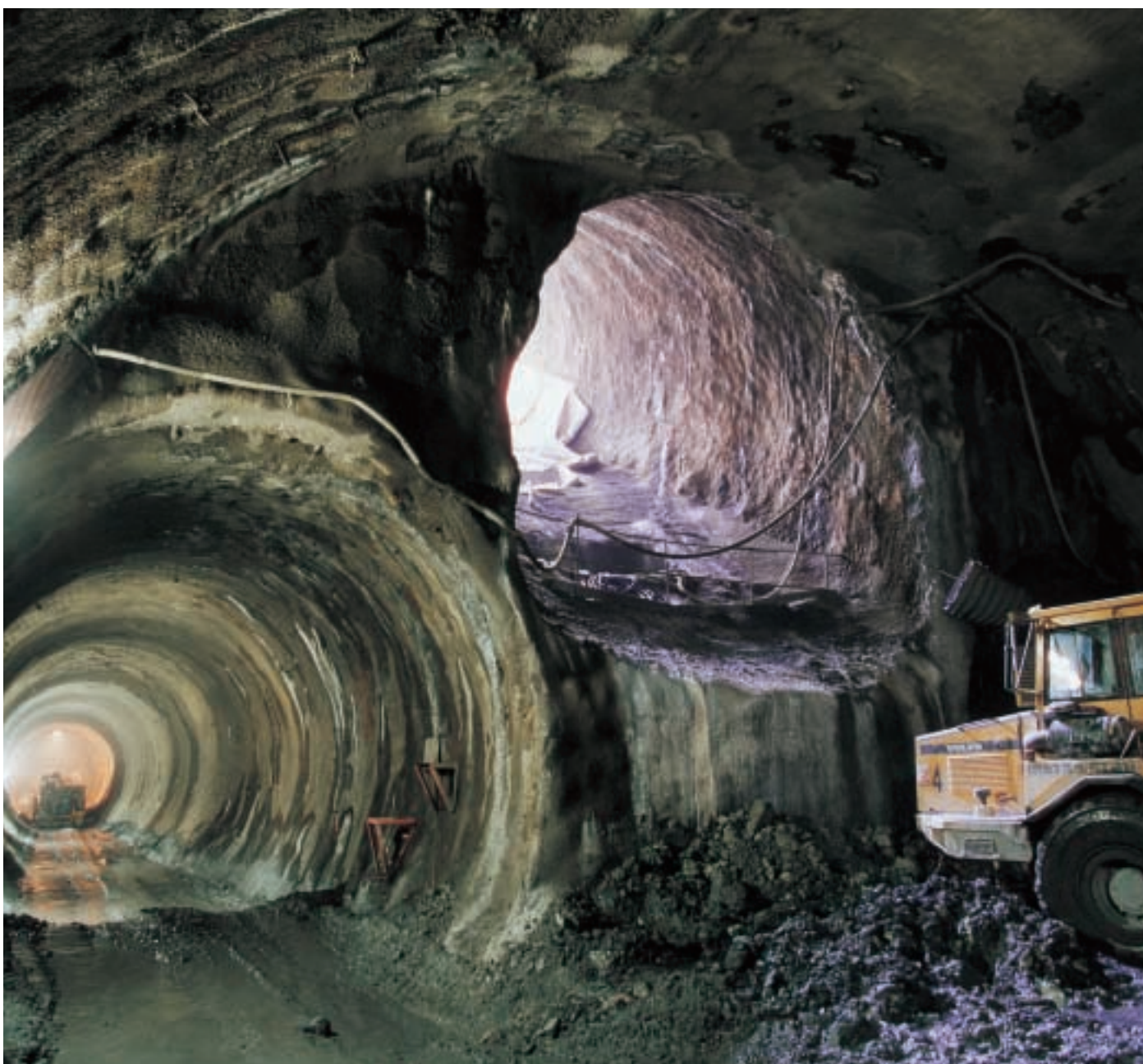
Obr. 5 Detail prostupu jednokolejného a eskalátorového tunelu do čela staničního profilu Fig. 5 Single-track tunnel and escalator tunnel entering the station profile
