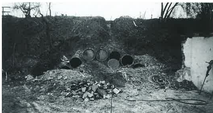
Obr. 1: Umelo vytvorená klenba z ocelových rúr priemeru 600 mm pretlačených nad profilom budúceho priepustu v násype železničnej trate (Radotín pri Prahe).
