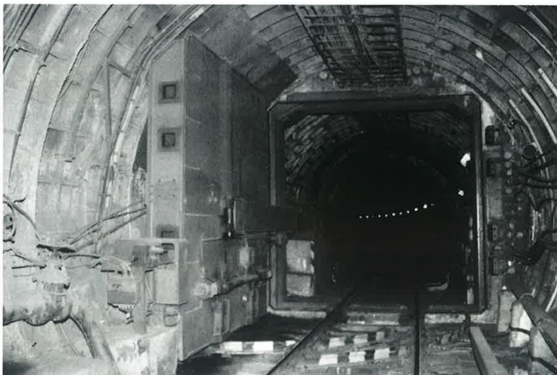
Ochranný systém metra
